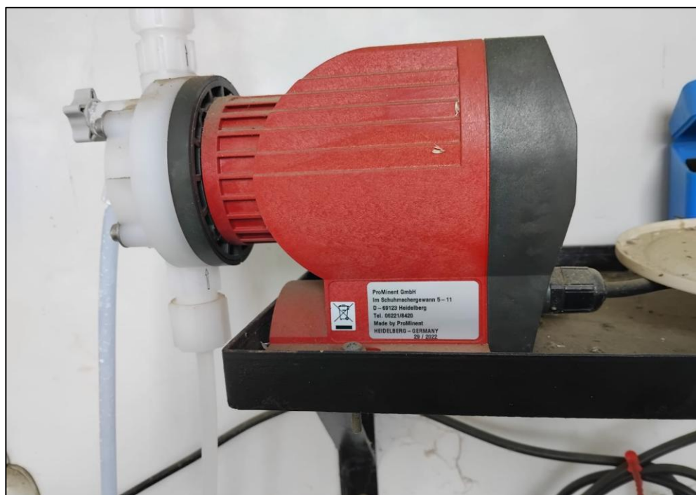
Bomba Dosificadora de Cloro
