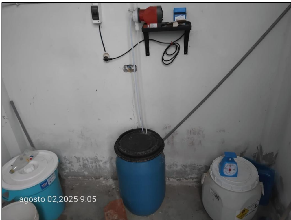
Sistema de cloración
