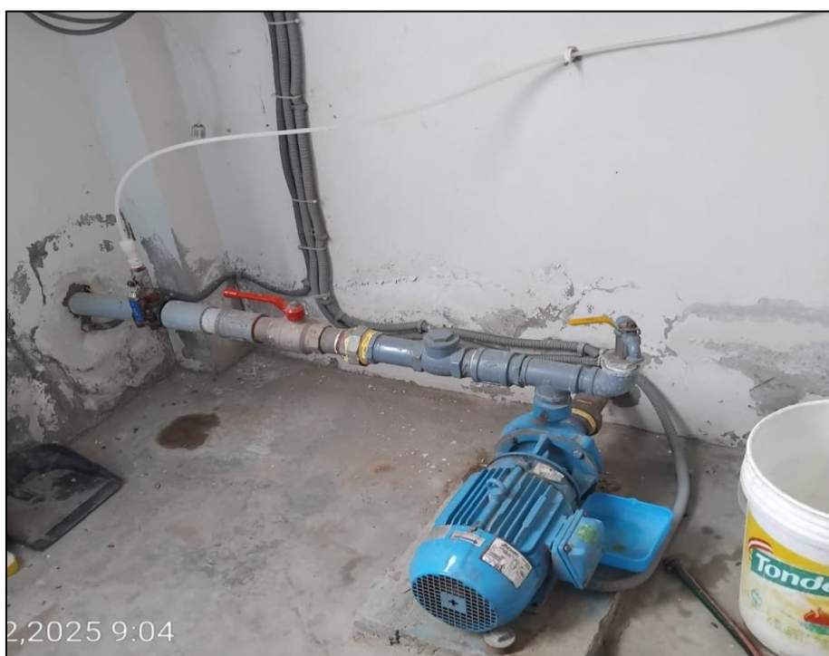
Equipo de bombeo
