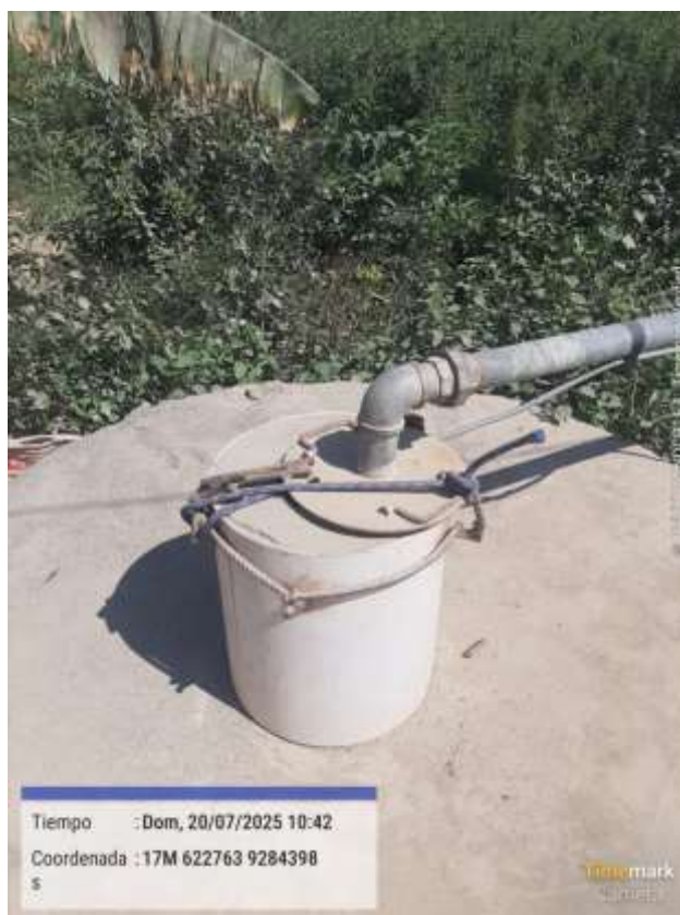
Fotografía 2: Pozo tubular incluye la bomba sumergible
