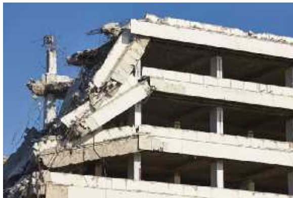
Fig. 21: Nivel de destrucción por efecto sísmico
