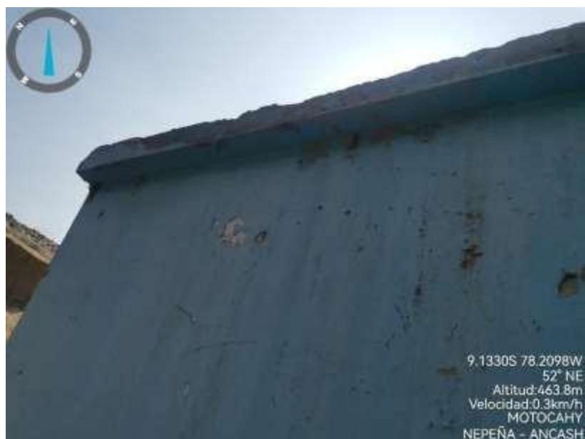
Fotografía 07: Vista de reservorio evidentemente deteriorado.
