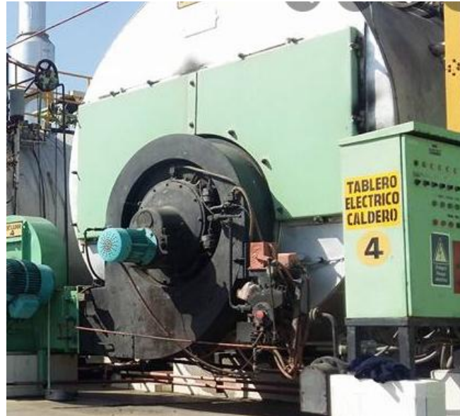
Vista frontal Caldero 4
