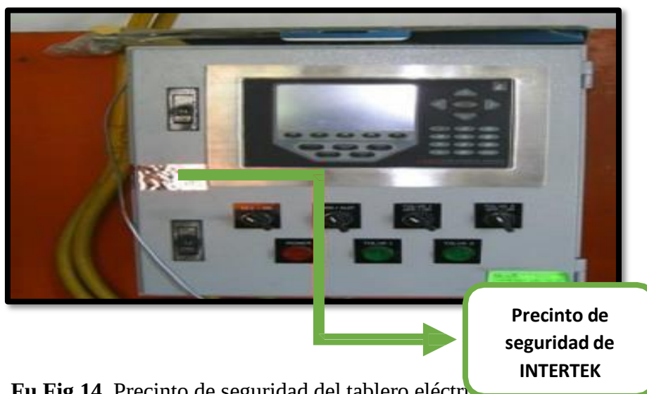
Fu Fig.14. Precinto de seguridad del tablero eléctrico
