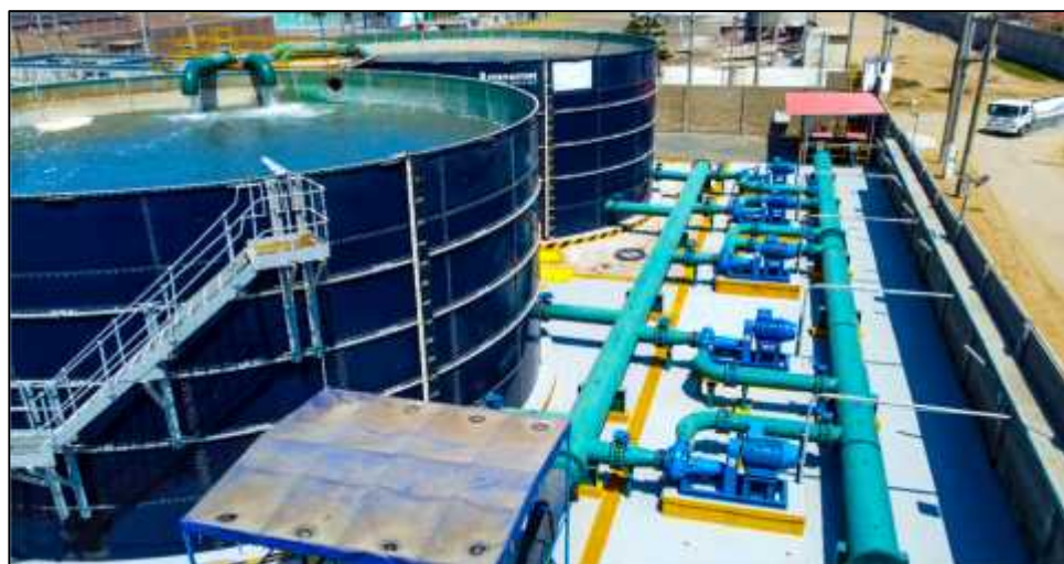
Figura 10: Estación central de bombeo de efluentes tratados APROFERROL
