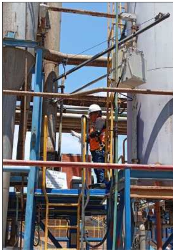
Punto de medición de emisiones atmosfericas en planta evaporadora de agua de cola (EA-01)
