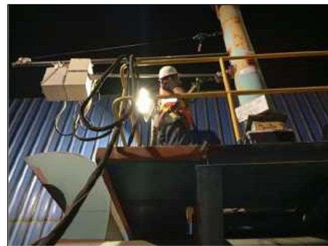
Punto de medición de emisiones atmosfericas en enfriador de harina (EA-03)
