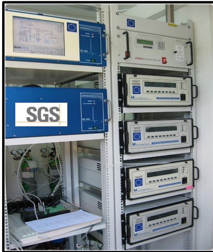
Fig. N°12: Shelter con Torre de Analizadores Continuos – CO
