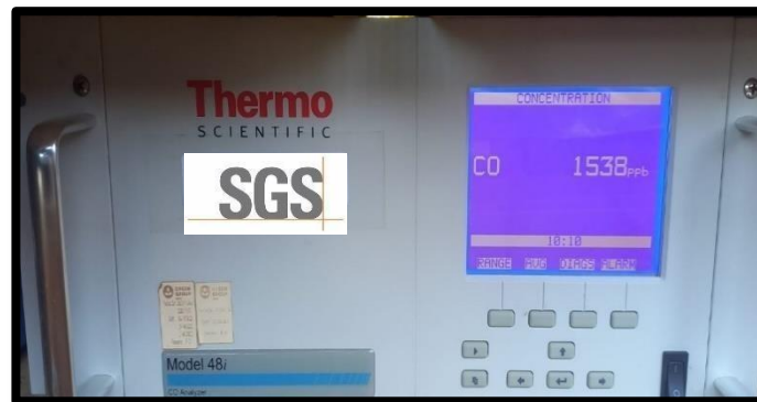
Fig. N°14: Pantalla Central - Analizador Continuo CO
