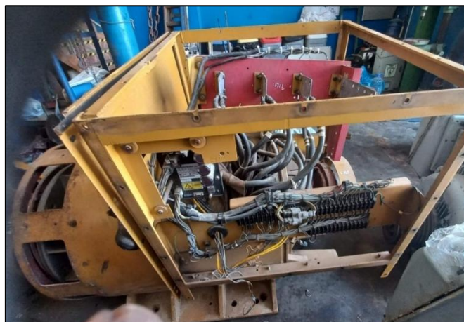
Generador eléctrico CAT 3304
