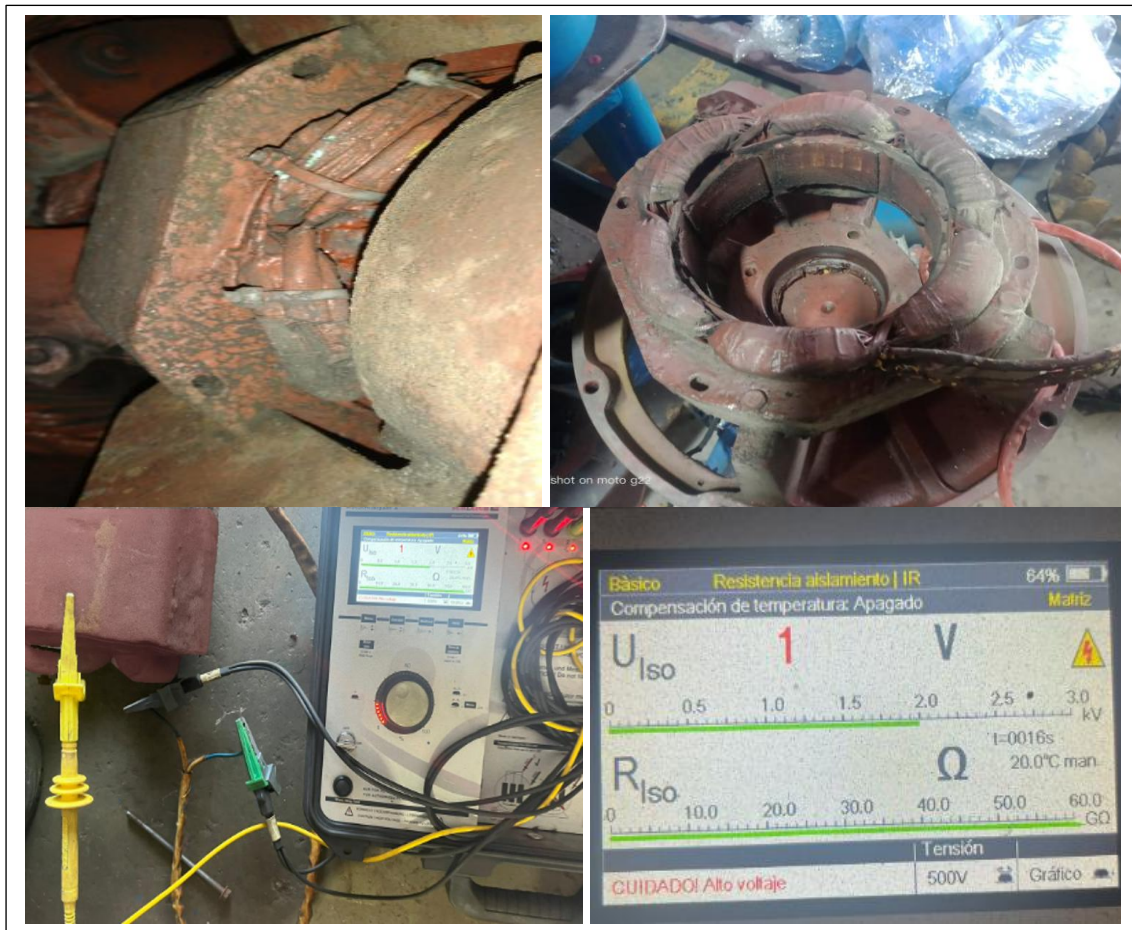
Pruebas de aislamiento del bobinado de la estática
