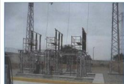
Pruebas Eléctricas al seccionador de Línea
