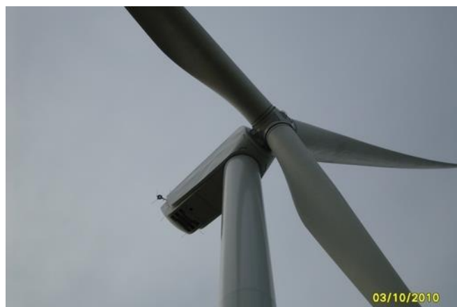
Aerogenerador Nordex N100/2500
