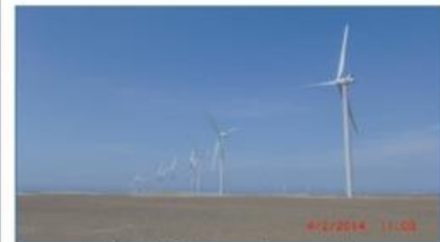
Vista de los Aerogeneradores montados
