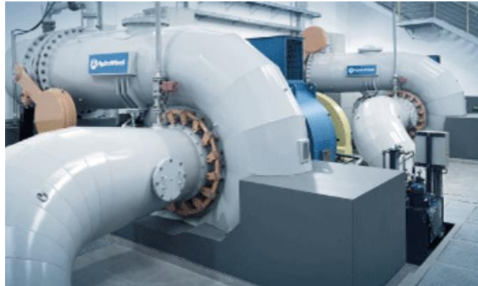
Turbina Francis de eje horizontal.
