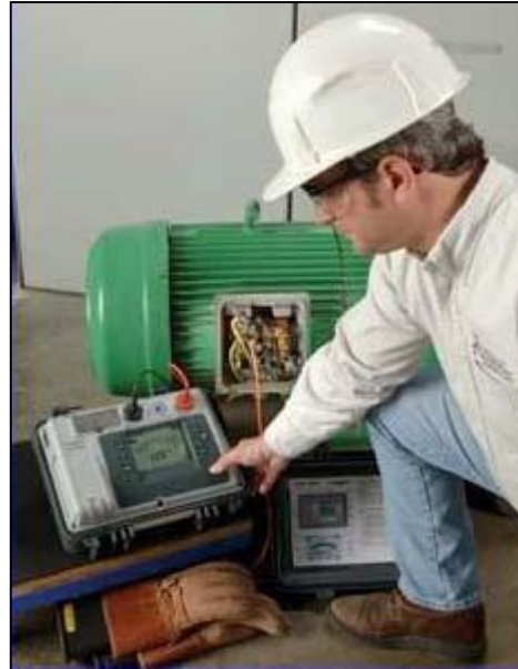
Fig. II.38: Evaluación del Generador
