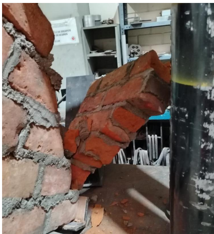
Foto 10: Falla por compresión diagonal en murete de albañilería
