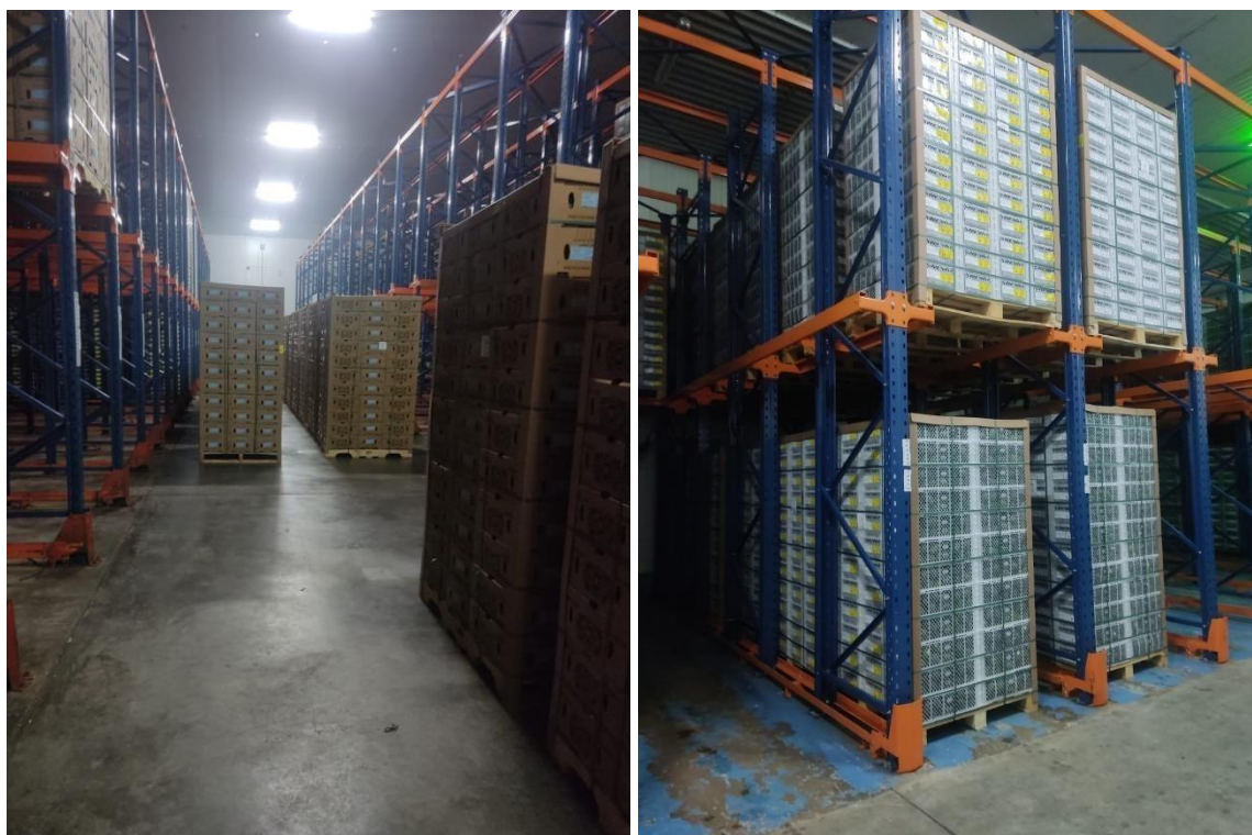
Figura 35 Foto de cámara de producto terminado de TAL S.A.
