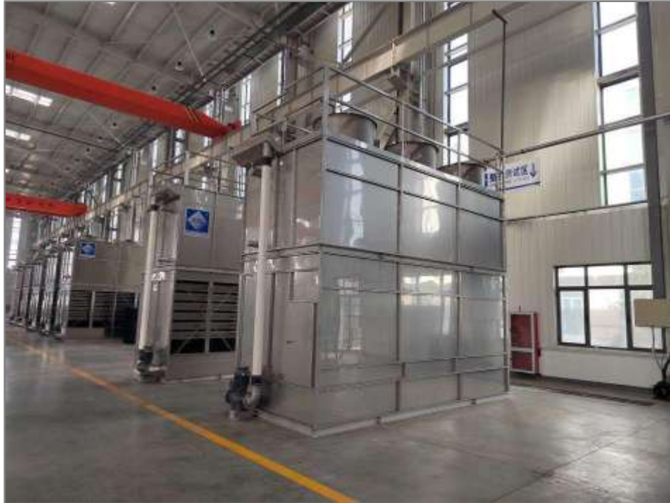
Figura 25 Condensador Evaporativo Weifang
