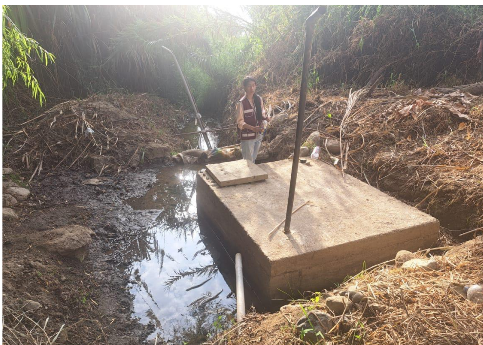
Vista de la Infraestructura de Captación de agua potable
