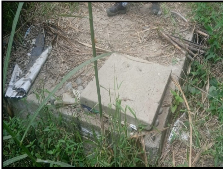
FOTO N°1 CAPTACIÓN QUE ABASTECE A LA LOCALIDAD VINCHAMARCA
