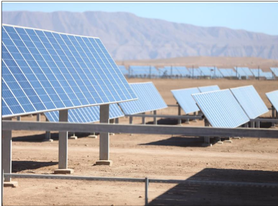
Central Solar Rubí
