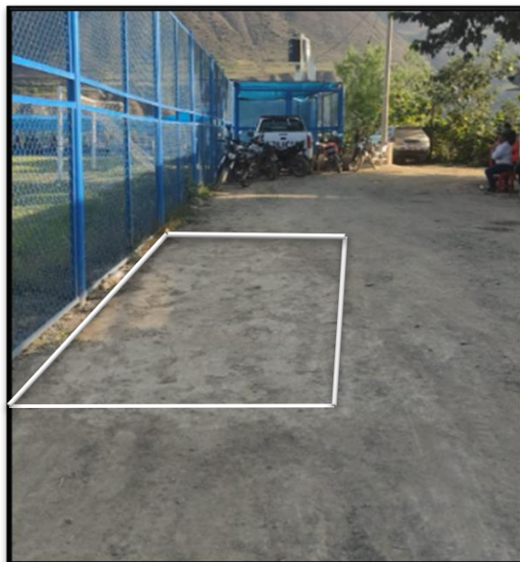
Fotografía 45 Evaluación del tramo de prueba realizado en la carretera San Blas Macate luego de 15 días de realizada la compactación.
