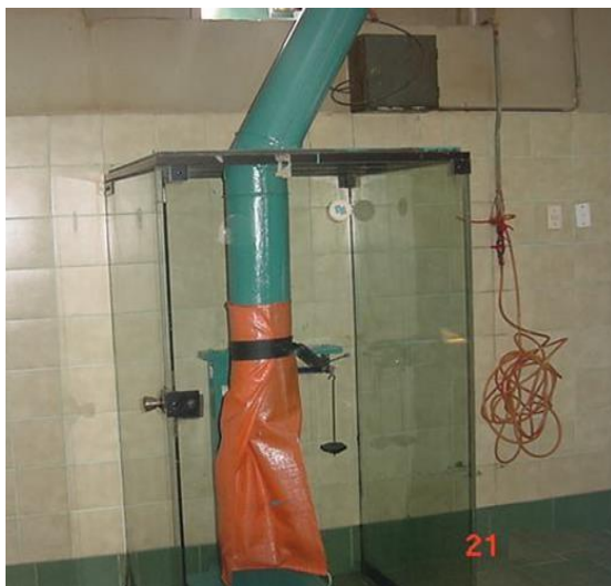
Fig. 07. “Chute” de sala de ensaque.
