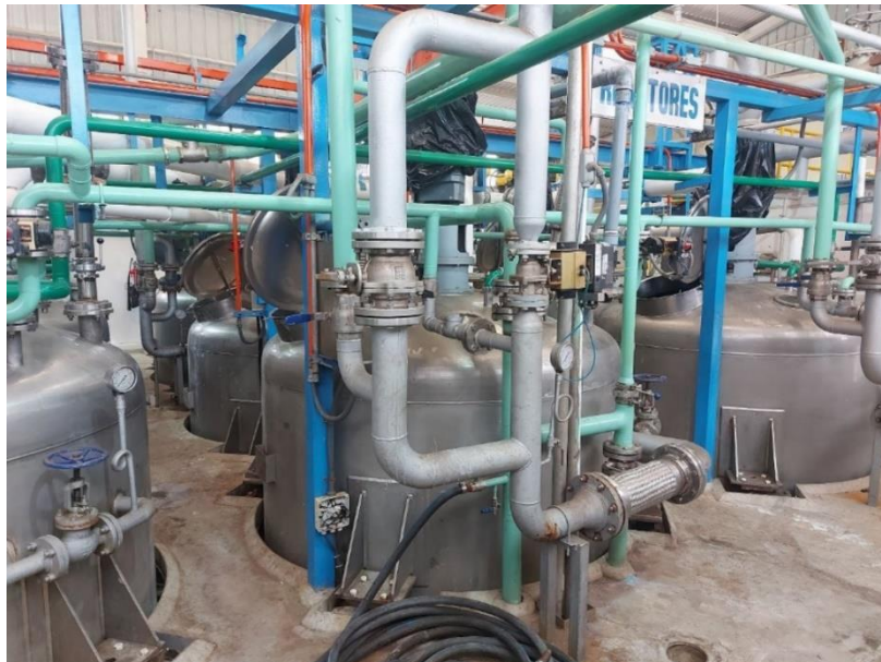
Figura 28. Reactores de la planta de COLPEX INTERNATIONAL S.A.C.
