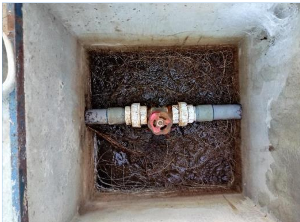
Válvula de salida de captación de C.P. Nueva Victoria
