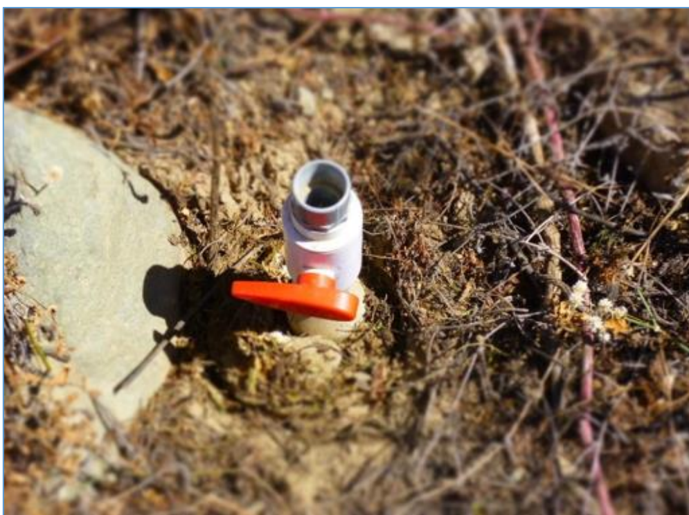
Válvula de Aire de captación de C.P. Nueva Victoria
