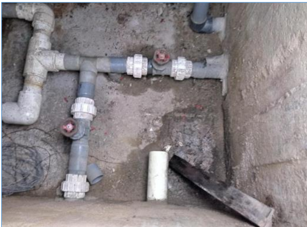
Caja de válvulas del C.P. Salitre
