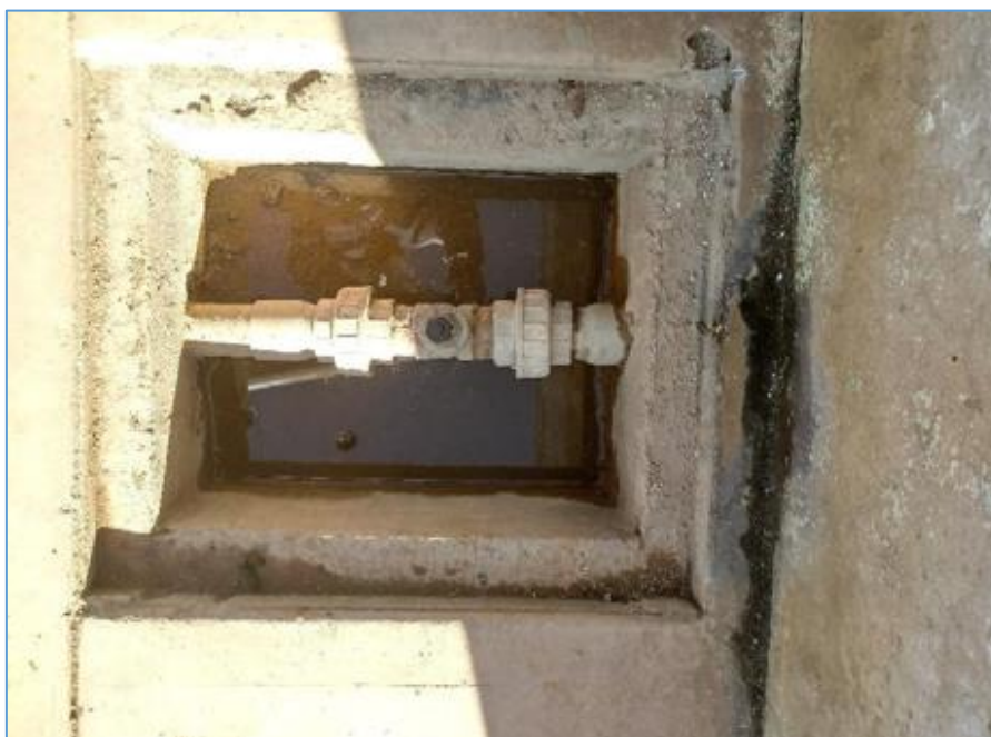
Caja de válvula de salida reservorio C.P. Nueva Victoria
