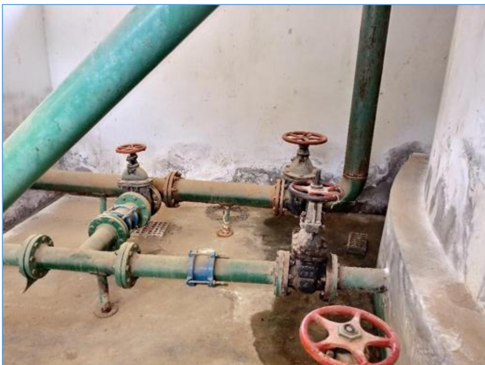
Caseta de válvulas del Centro Poblado de Jimbe
