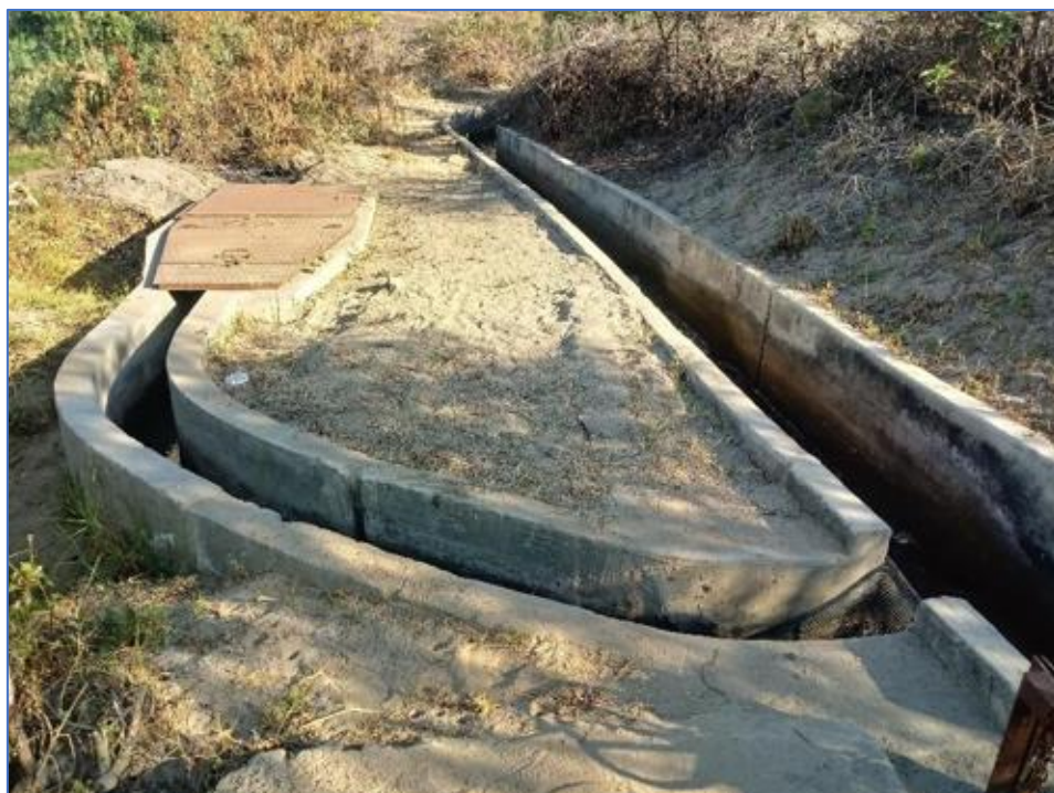
Cámara y canal de captación C.P. Jimbe
