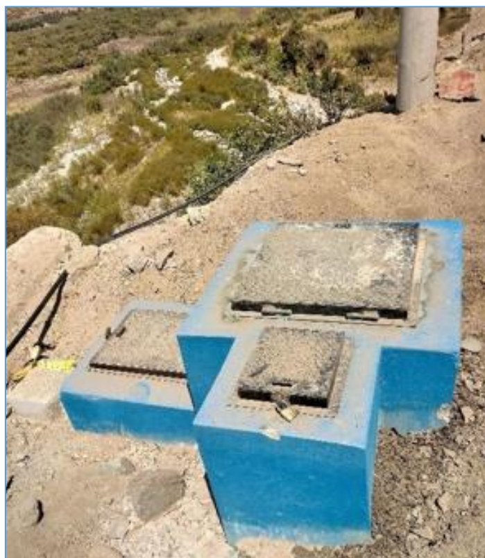
Cámara rompe presión VI de C.P. Macracancha
