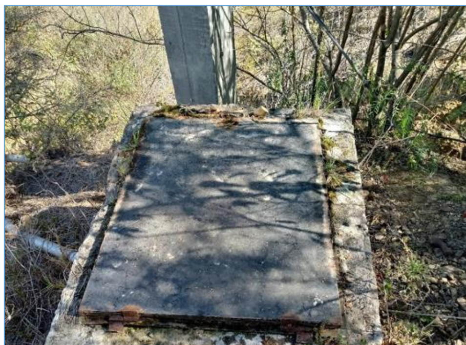
Cámara rompe presión tipo IV del C.P. Jimbe
