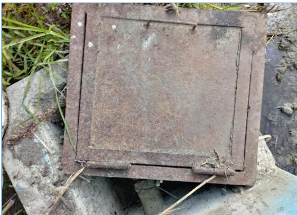
Caja de válvula de captación del C.P. Huanca
