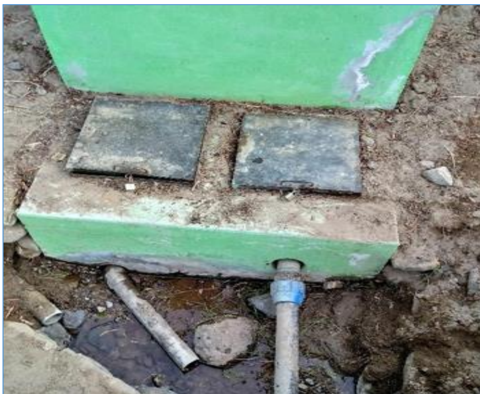
Caja de válvulas de captación de C.P. Salitre
