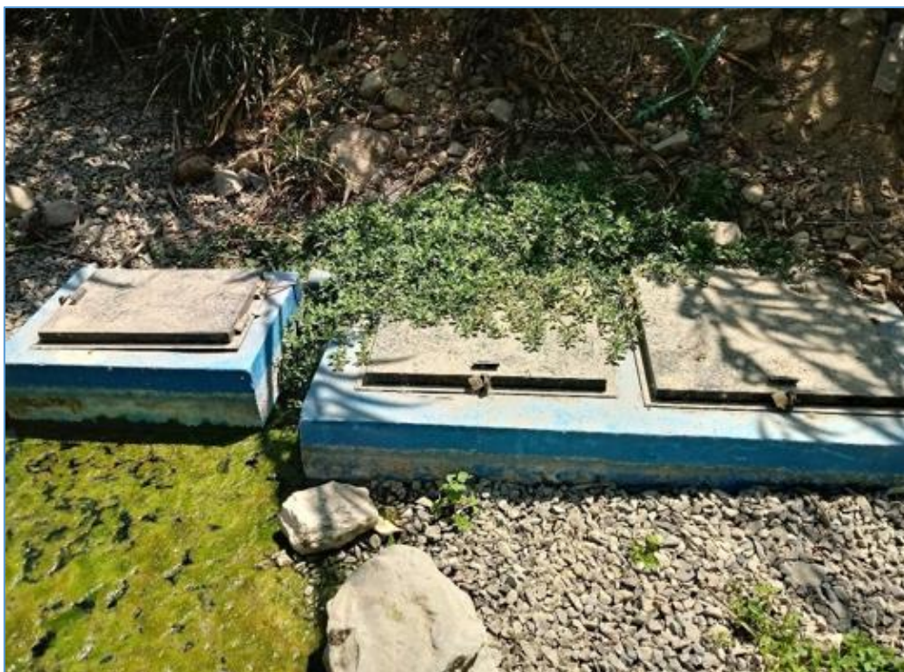
Captación del C.P. Macracancha
