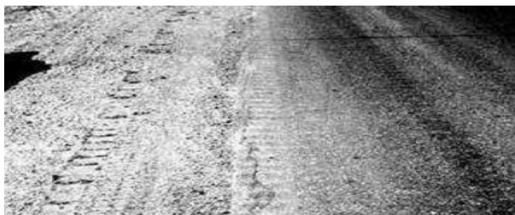
Figura 22. Fisura de reflexión de junta -Severidad Low
