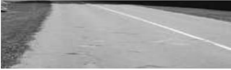
Figura 50. Peladura por intemperismo y desprendimiento de agregados- Severidad High
