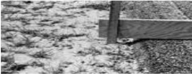
Figura 25. Desnivel carril-berma -Severidad Low
