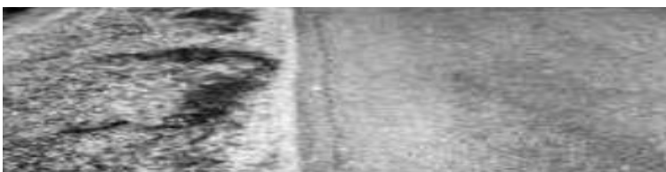
Figura 19. Fisura de borde -Severidad Low
