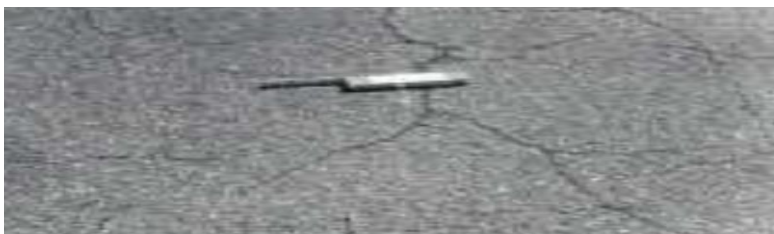
Figura 7. Fisura en bloque -Severidad Low
