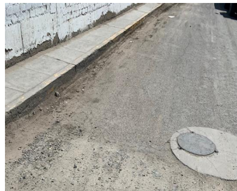
Grieta de borde
