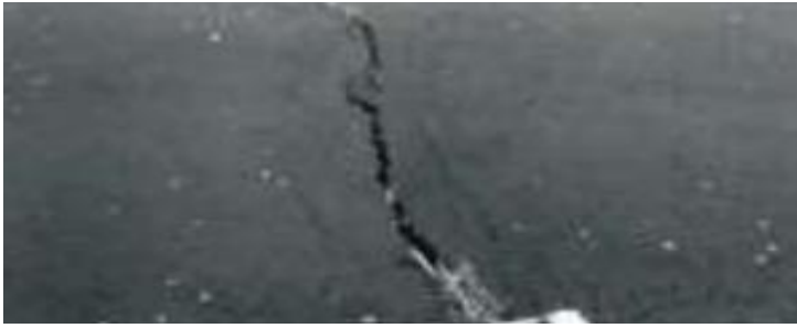
Figura 30. Fisuras longitudinales y transversales -Severidad High
