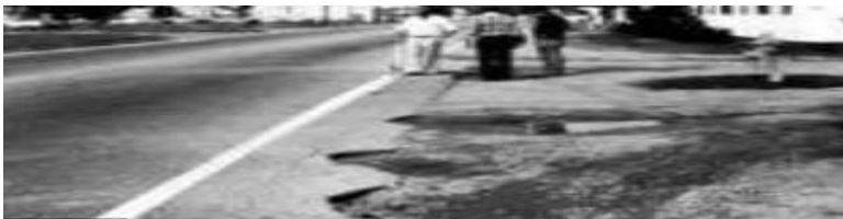
Figura 21. Fisura de borde -Severidad High
