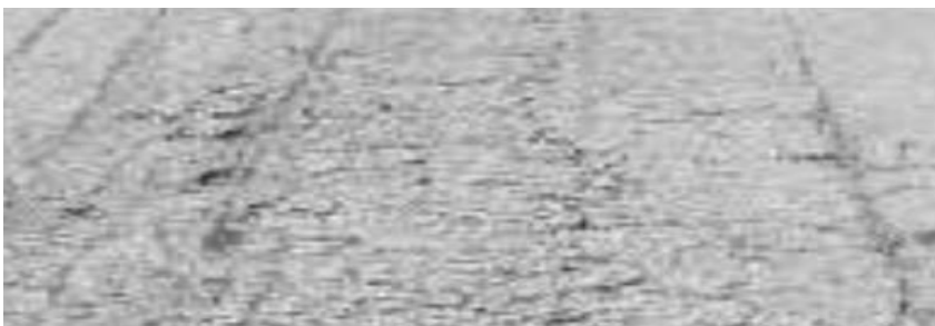
Figura 49. Peladura por intemperismo y desprendimiento de agregados- Severidad Low
