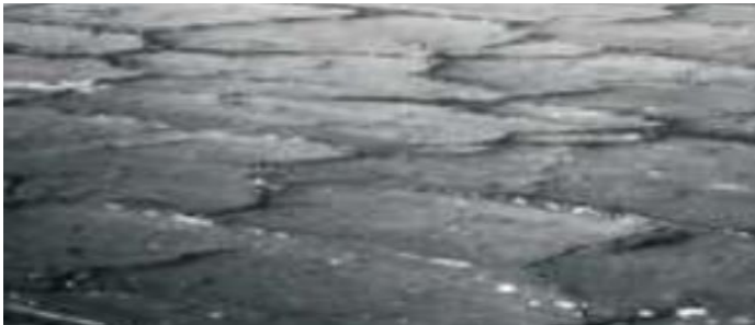
Figura 9. Fisura en bloque -Severidad High
