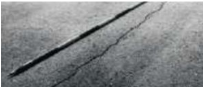
Figura 29. Fisuras longitudinales y transversales -Severidad Medium
