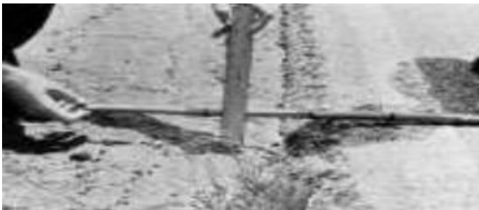
Figura 26. Desnivel carril-berma -Severidad Medium
