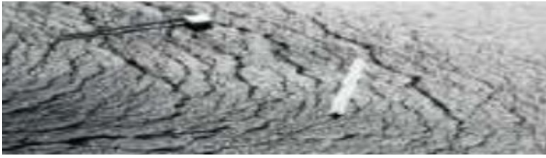
Figura 45. Fisura parabólica-Severidad Medium
