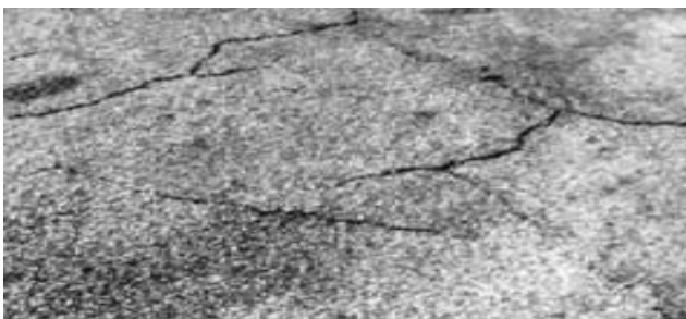
Figura 10. Abultamiento -Severidad Low
