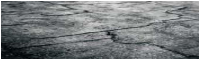
Figura 8. Fisura en bloque -Severidad Medium
