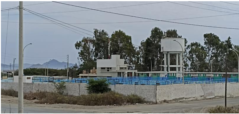
Gráfico 8: Planta de SEDACHIMBOTE – Planta de Tratamiento de Agua Potable Av. Industrial – Urb. Bellamar – Nuevo Chimbote
