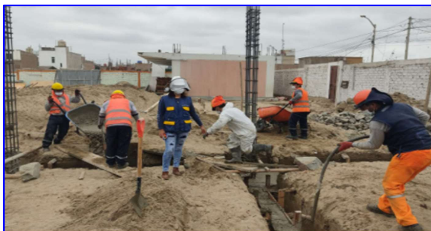
FIGURA N°21. Vaciado y vibrado de concreto para vigas de cimentación f'c=210 kg/cm, Colegio 88393.
