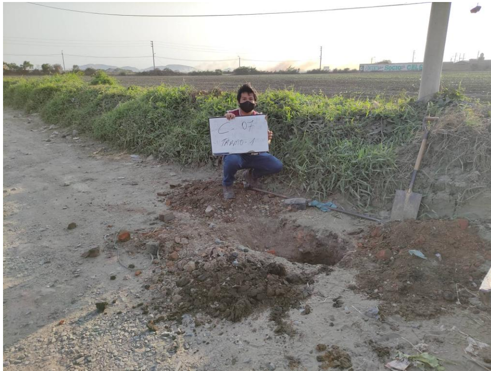
Fotografía N°7. Excavación y selección de muestra de la calicata #6 en una vía de acceso.
