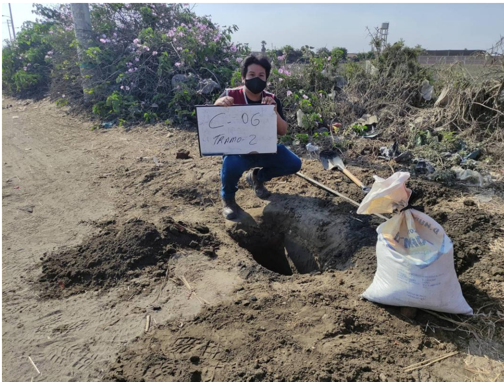
Fotografía N°5. Excavación y extracción de muestra de la calicata #6 en una vía de acceso.
