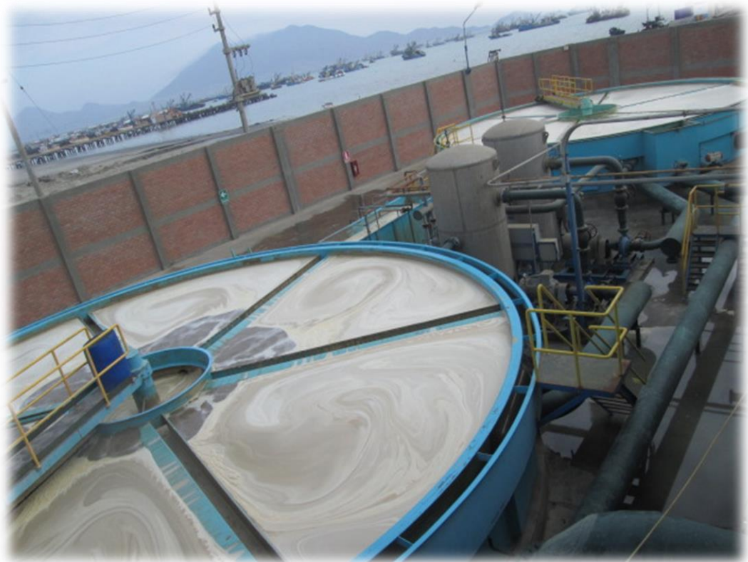
Gráfico 5. Celda de flotación DAF, (Dilution Air Flotation).
