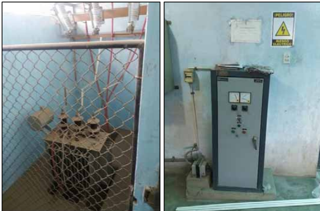
Pozo N° 7: Transformador de energía para el funcionamiento del motor de equipo de bombeo; tablero de control de encendido y apagado de motor.
