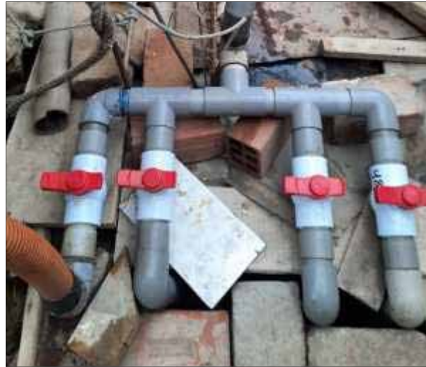
Pozo B2: Extracción de agua subterránea para fines domestico y riego a 3 l/s, con una bomba sumergible.
