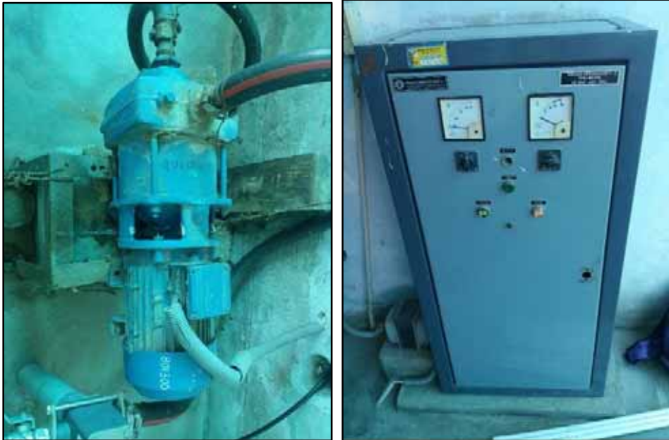
Pozo N° 6: Bomba para mezclar el gas de cloro con el agua extraída del pozo; tablero de encendido y apagado del motor.
