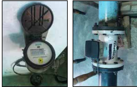
Pozo N° 7: Caudalímetro macromedidor electrónico y accesorio instalado en la tubería de impulsión.
