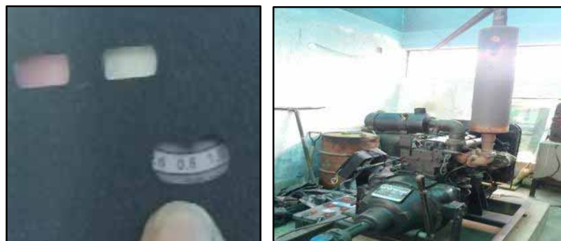
Pozo N° 7: Prueba de cloro residual el cual marca 0.8 mg/L; equipo de bombeo alternativo se encuentra conectado a la turbina vertical y funciona cuando no existe fluido eléctrico.
