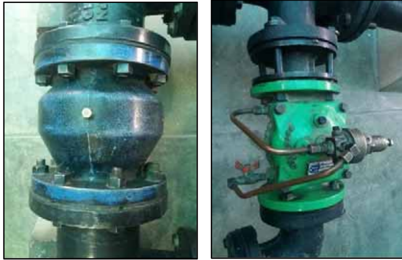
Pozo N° 7: Válvula check en la tubería de impulsión; válvula de alivio.
