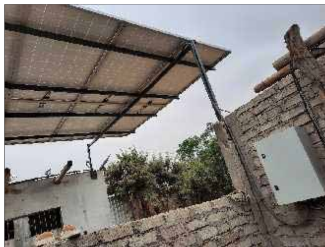
Pozo B2: Tablero de control de energía eléctrica; Techo de panel solar como fuente de energía.
