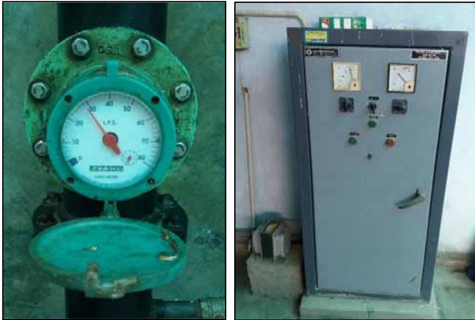
Pozo N° 5: Caudalímetro macromedidor, tablero de control de encendido y apagado del sistema de bombeo.
