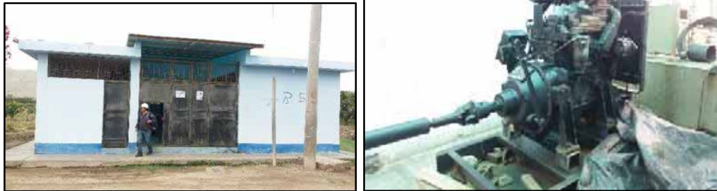
Pozo N° 5: Caseta de bombeo; máquina de bombeo alternativo funciona cuando no existe fluido eléctrico.
