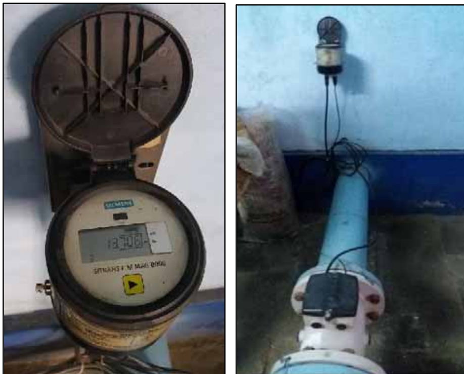
Pozo N° 1: Caudalímetro macromedidor, accesorio del medidor de caudal colocada en la tubería de impulsión.
