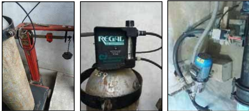
Pozo N° 7: Balón de cloro, balanza, regulador de cloro y bomba para mezclar el gas de cloro con el agua extraída del pozo.
