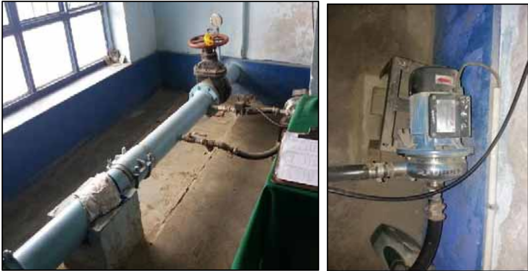
Pozo N° 1: válvula de compuerta de tubería de impulsión. Manómetro de presión, bomba para mezclar el gas de cloro con el agua extraída.
