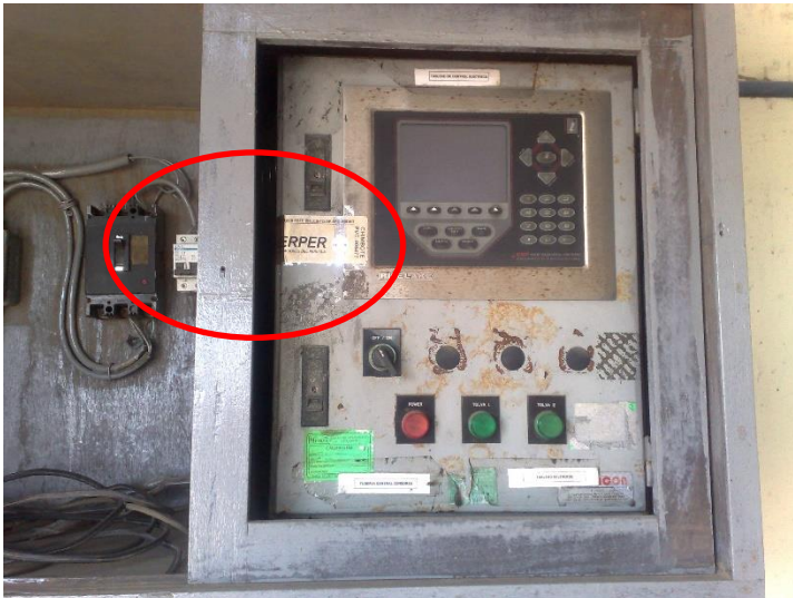
Figura 37. Precinto esticker en el tablero de control eléctrico.
