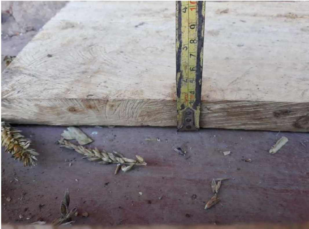
Figura 155. Verificación de las medidas de las maderas para piso de segundo nivel. Fuente: Toma propia.
