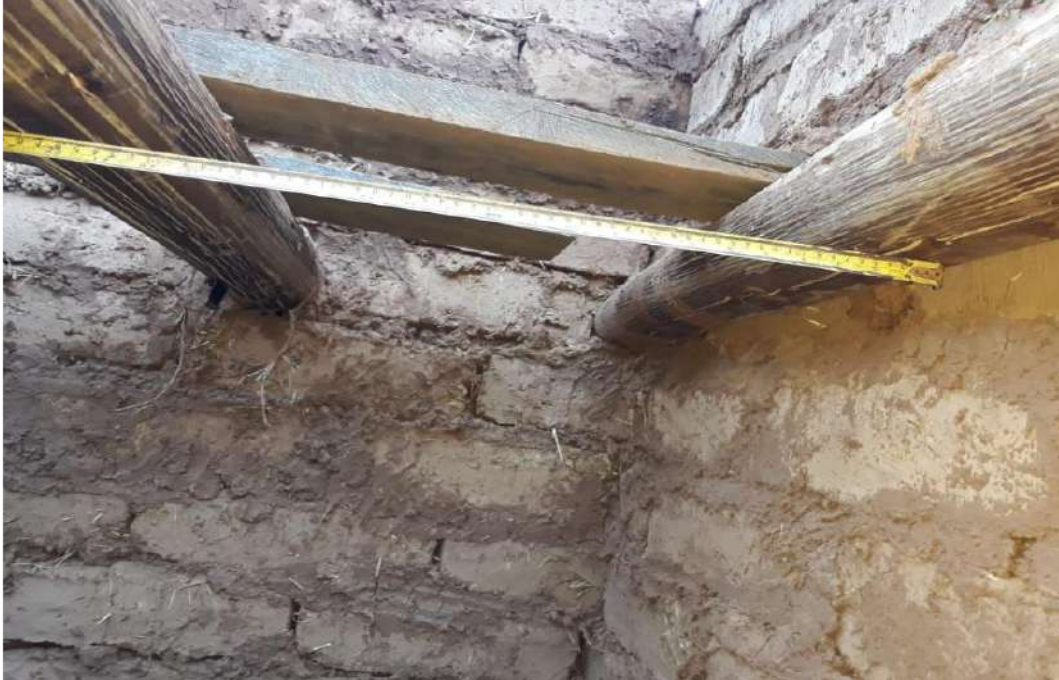
Figura 151. Verificación del espaciamiento entre vigas de eucalipto para techo. Fuente: Toma propia.
