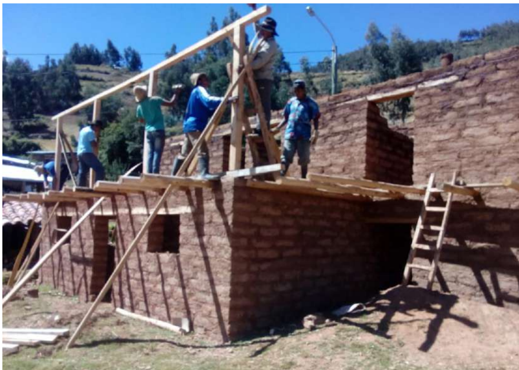
Figura 168. Levantamiento y armado de columnas de eucalipto para tijerales de segundo nivel. Fuente: Toma propia.
