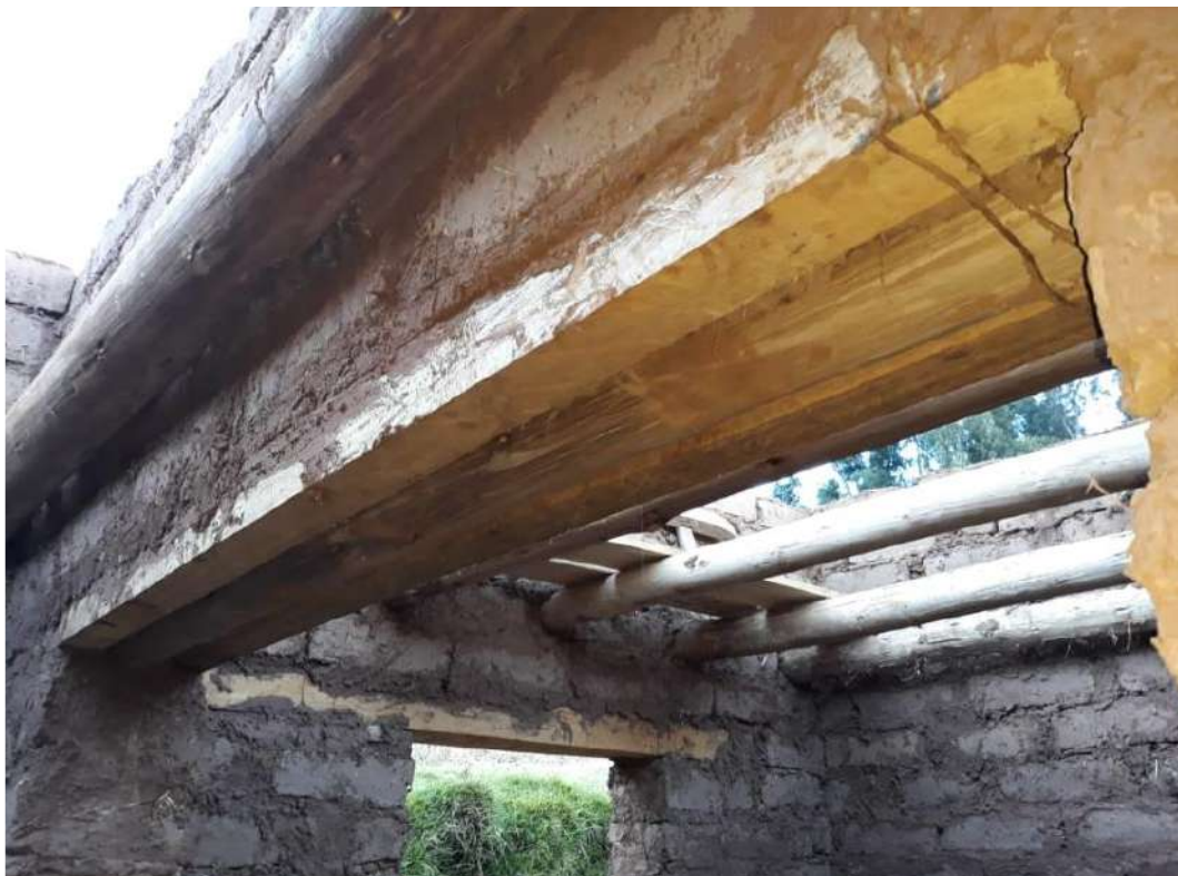
Figura 1526. Colocación y amarre de dinteles para puertas y ventanas, asegurados con alambre #8. Fuente: Toma propia.
