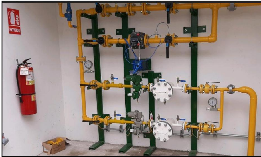
Figura 1: Estación de Regulación y medición de gas natural
