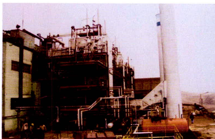
Figura N° 14 Central Termoeléctrica de San Nicolas
