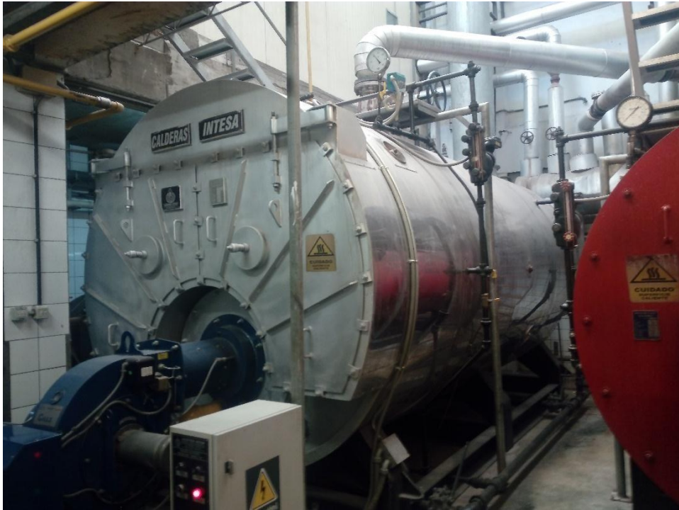
Figura 20: Caldera intesa 800 BHP
