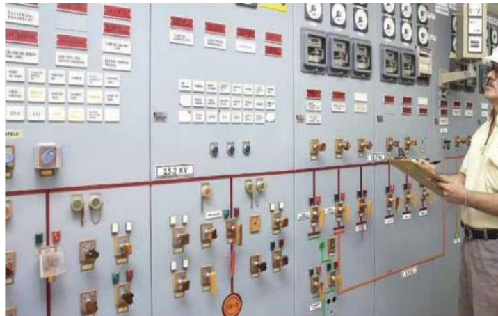
Figura N° 31: Sala de control de la Central Termoeléctrica de Reserva Frio de Ilo
