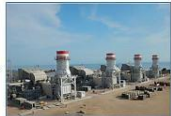
Turbinas y Generadores 1, 2, 3 y 4
