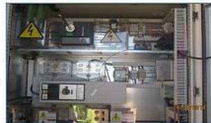
Vista del conexionado del inversor
