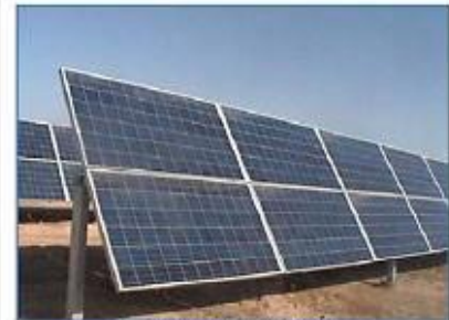
Módulos Solares Instalados
