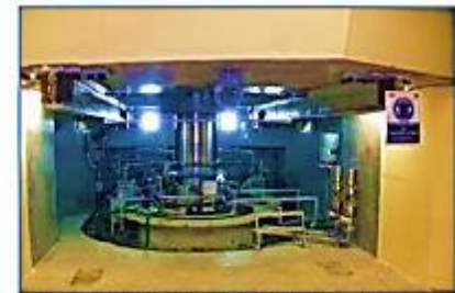
Eje de Acoplamiento Turbina-Generador Eléctrico
