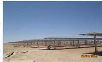
Módulos fotovoltaicos instalados
