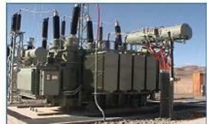
Transformador de Potencia 20 MVA, 23/138 kV
