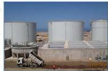
Tanque de Almacenamiento Combustible Diésel B5
