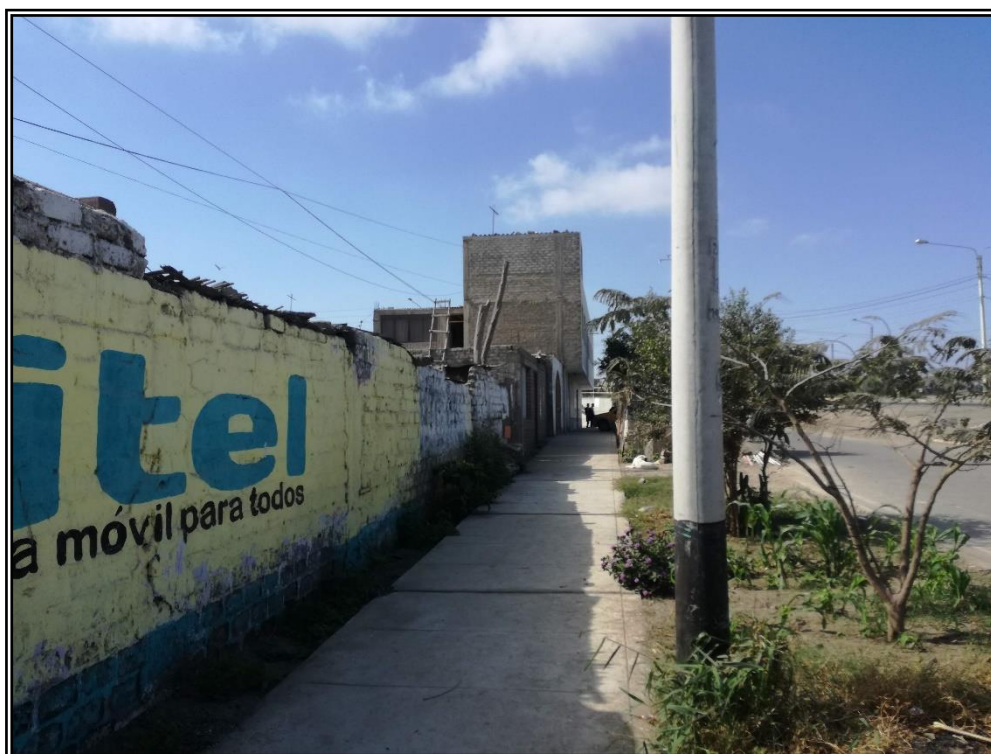
FOTO N° 12: Cerco perimétrico de vivienda que no presenta cimentación, de muro no confinado vertical ni horizontalmente, presentando un diagnóstico de la Vulnerabilidad Estructural Alta.
