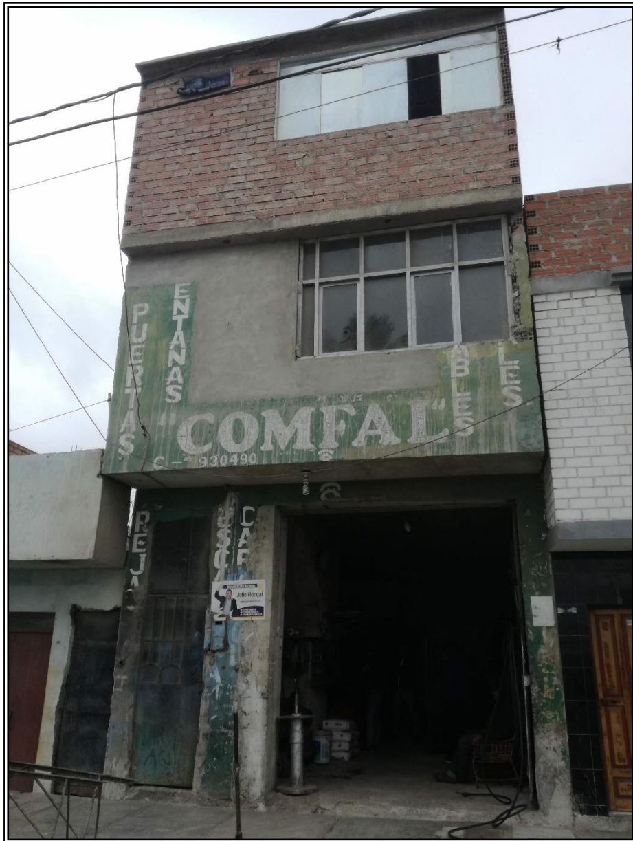
FOTO N° 06: Se observa en el muro de la tercera planta, la utilización de diferentes unidades de albañilería sin confinamiento, el diagnóstico de la Vulnerabilidad Estructural es Alta.
