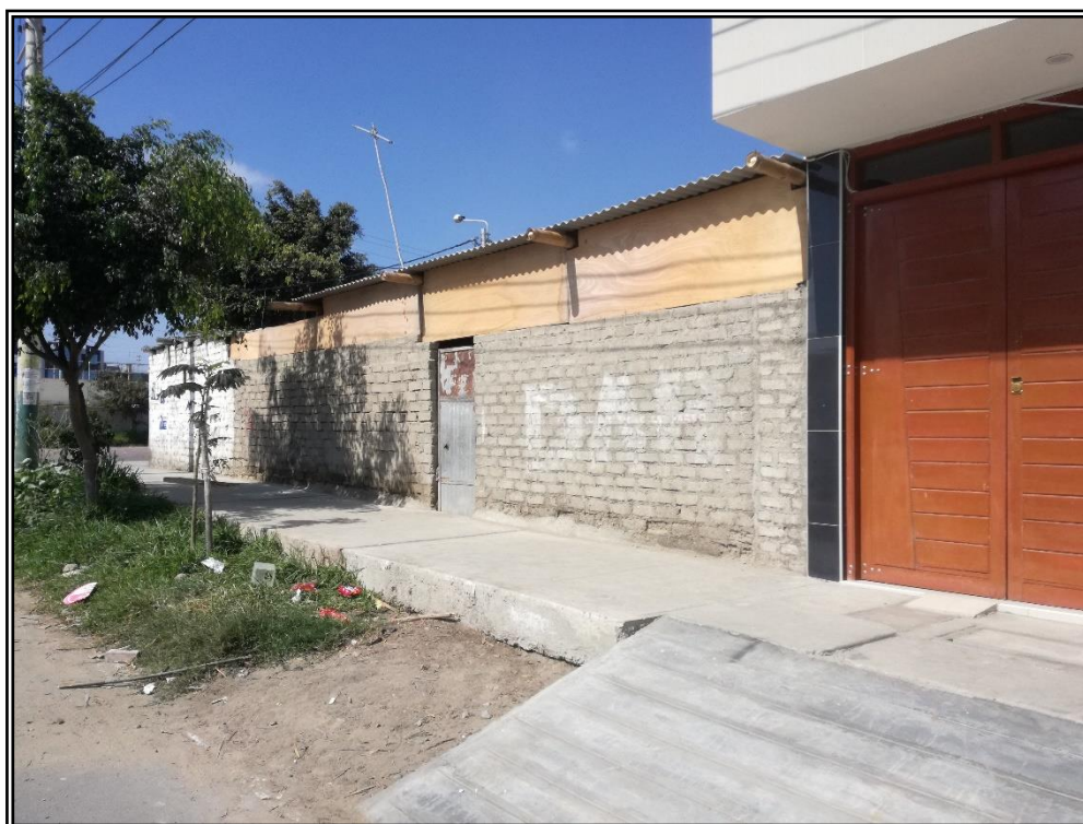
FOTO N° 13: Vulnerabilidad Estructural Alta, muro sin cimentación ni confinamiento.
