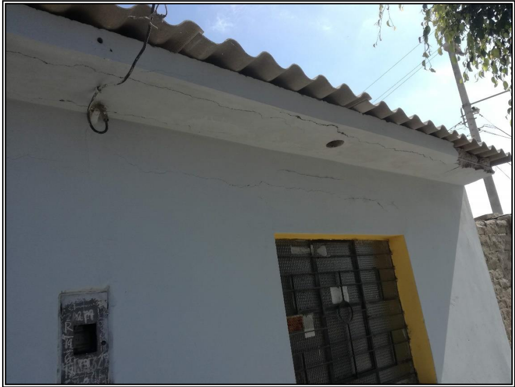
FOTO N° 07: Deficiente estado de conservación y mantenimiento del acero de columnas y vigas.
