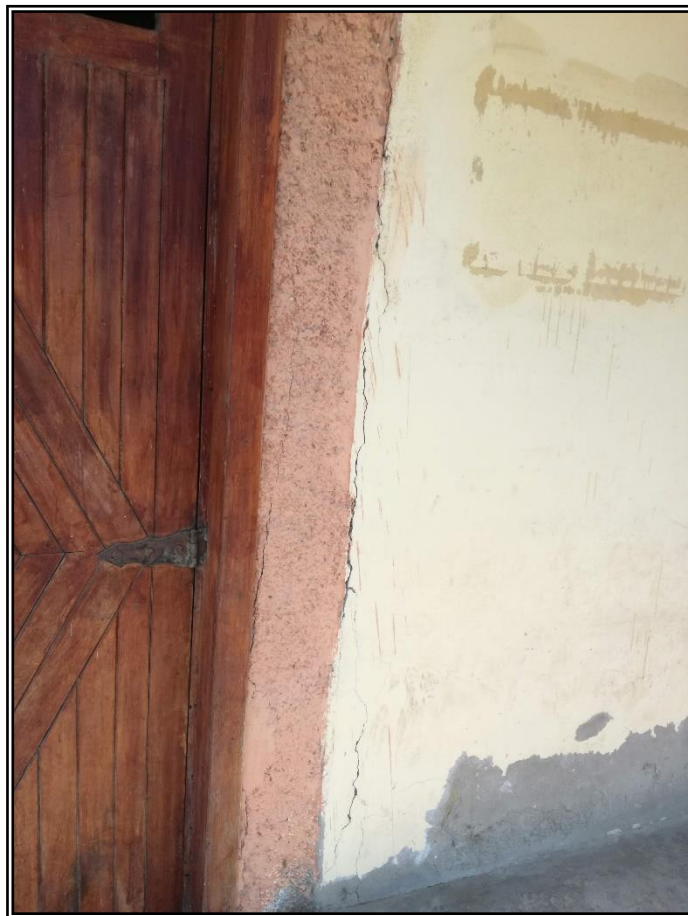
FOTO N° 18: Mal proceso constructivo en confinamiento muro - columna.
