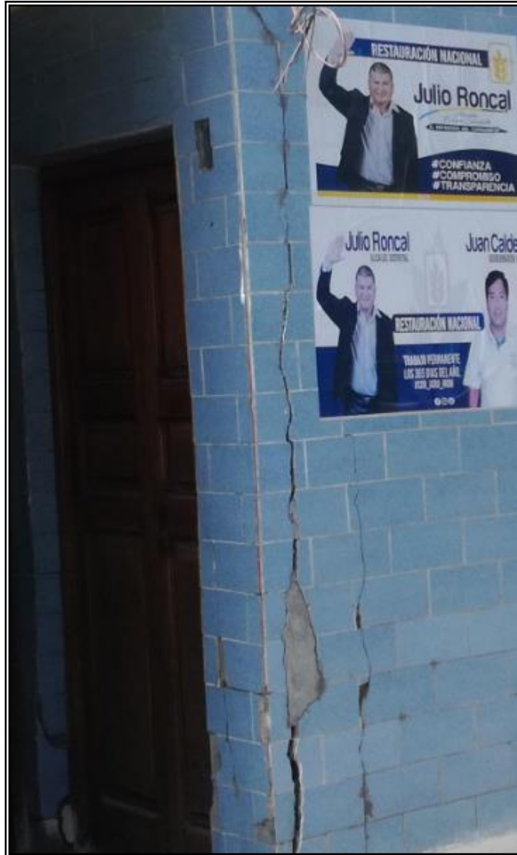
FOTO N° 21: Se puede observar el muy mal estado de la columna en la base, el cual se debería de demoler para mayor seguridad.
