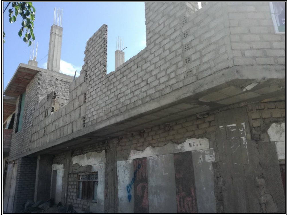
FOTO N° 05: Mala disposición de las unidades de mampostería, Vulnerabilidad Alta.
