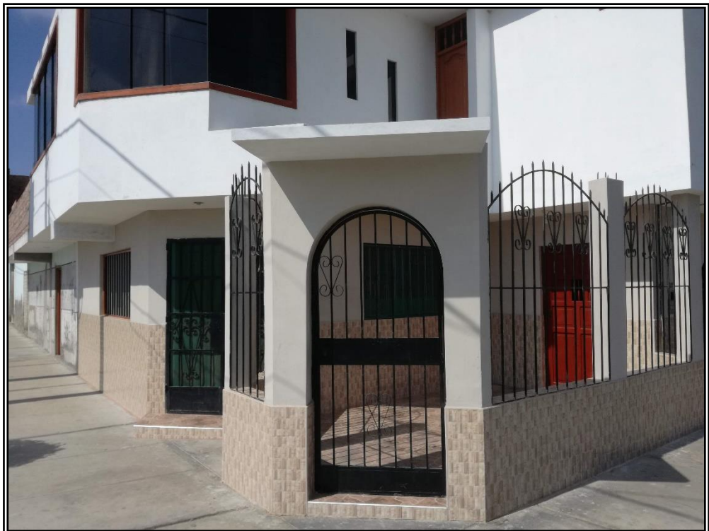
FOTO N° 02: Irregularidad en Planta y en Altura, Vulnerabilidad Estructural Geométrica Alta.
