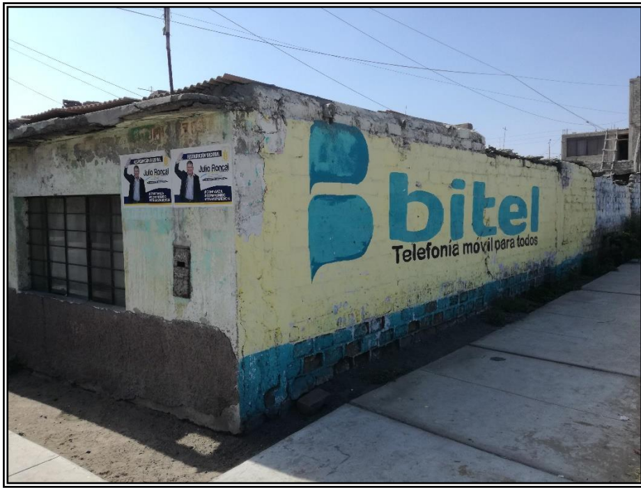
FOTO N° 17: Agrietamiento en muro, por falta de confinamiento, Vulnerabilidad Estructural Alta.
