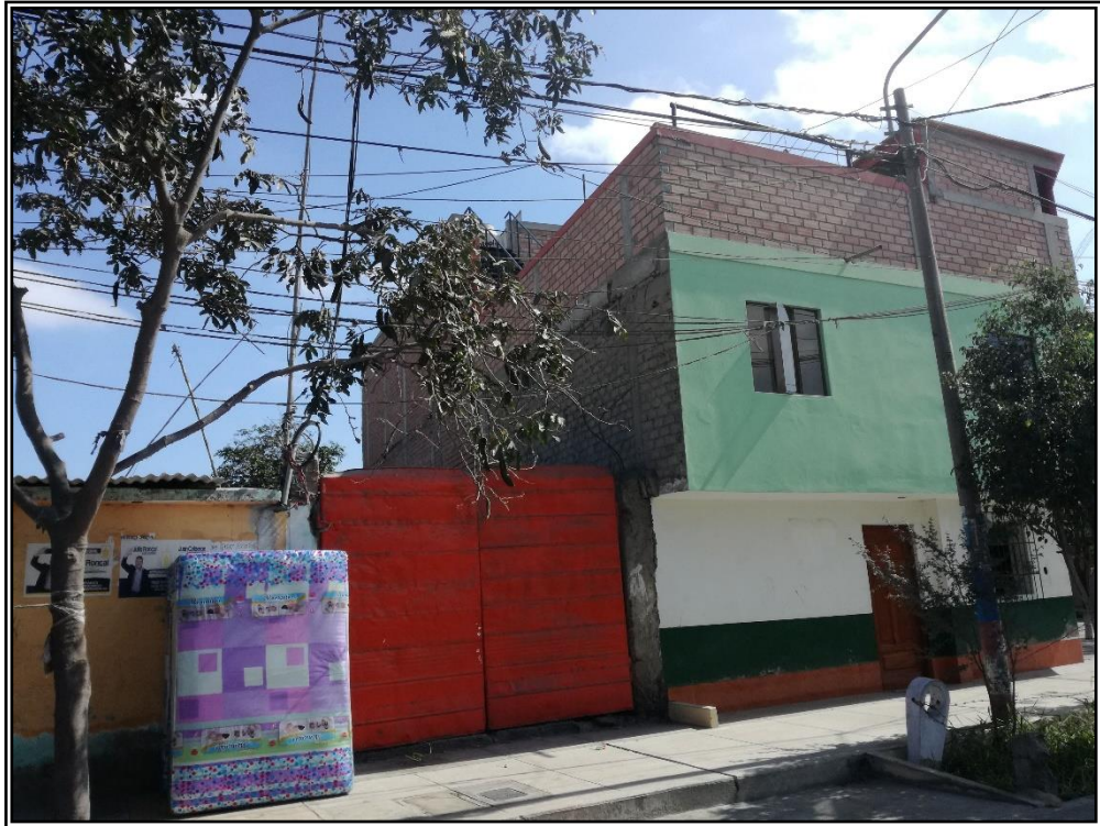
FOTO N° 11: Mala disposición y utilización de distintas unidades de albañilería, así como abertura en muro de forma inadecuada.
