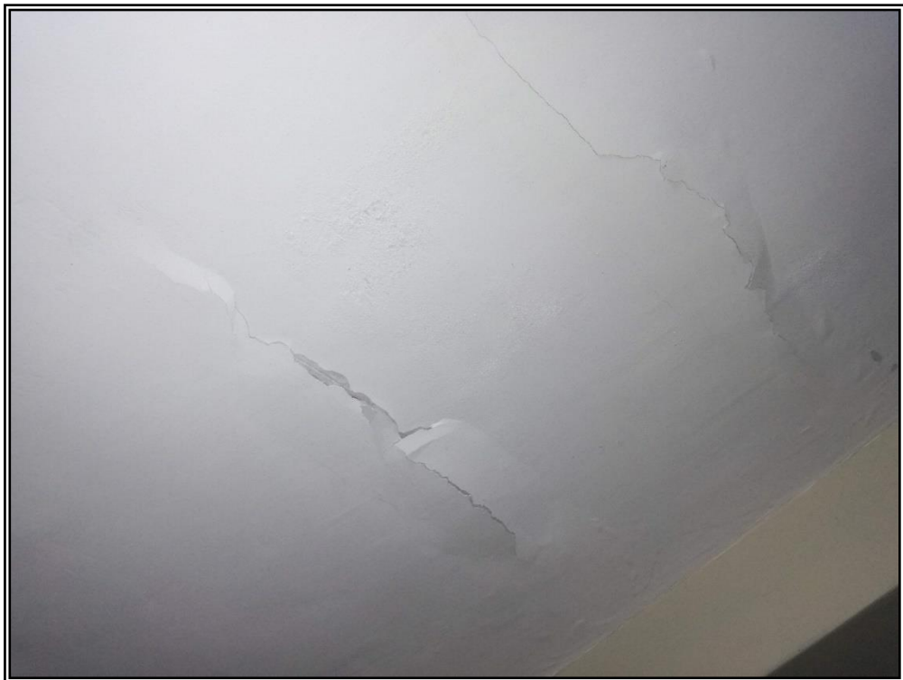
FOTO N° 16: Fisuras en piso de segundo nivel, deficiente estado de conservación y mantenimiento, ocasionando problemas de infiltración hacia la losa aligerada.
