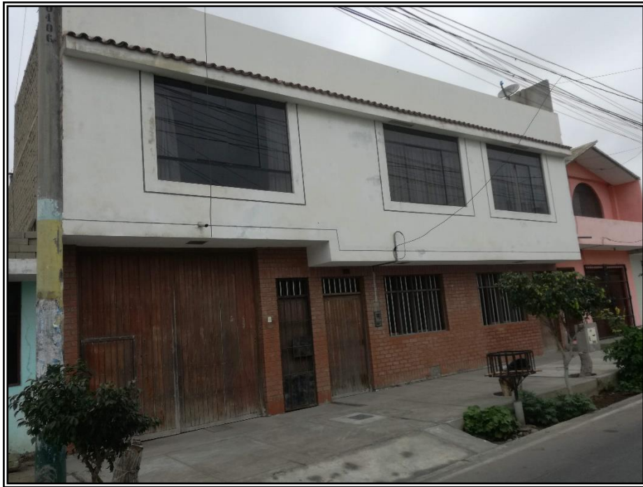
FOTO N° 14: Distintos niveles de entrepiso en una misma vivienda, presentándose una Vulnerabilidad Estructural de entrepiso del tipo Alta.
