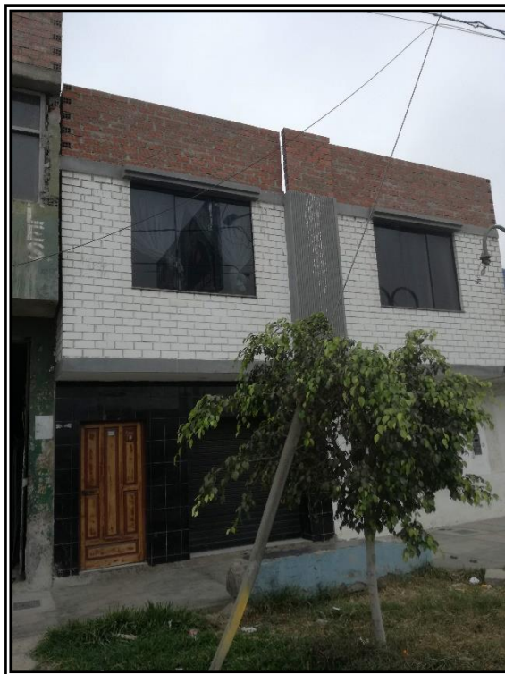
FOTO N° 9 y 10: Parapeto de fachada de 8m de largo y 1m de altura aproximadamente, sin confinar presentando una Vulnerabilidad Estructural Alta.
