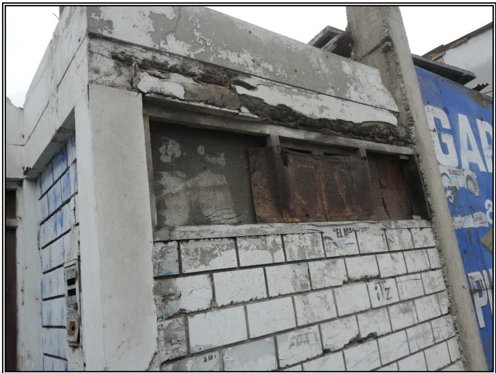
FOTO N° 08: Deficiente estado de conservación de vigas, además de la deficiencia en el proceso constructivo al no dejar la junta de construcción.
