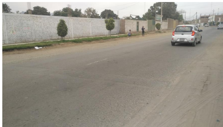
Figura 16: Deformación permanente de carpeta asfáltica – Av. Virú.
