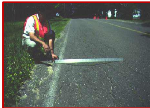
Figura 26. Falla tipo Depresión
