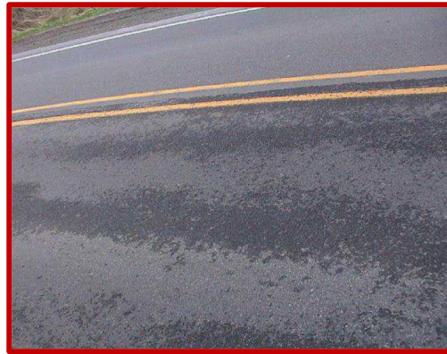
Figura 25. Falla tipo Exudación
