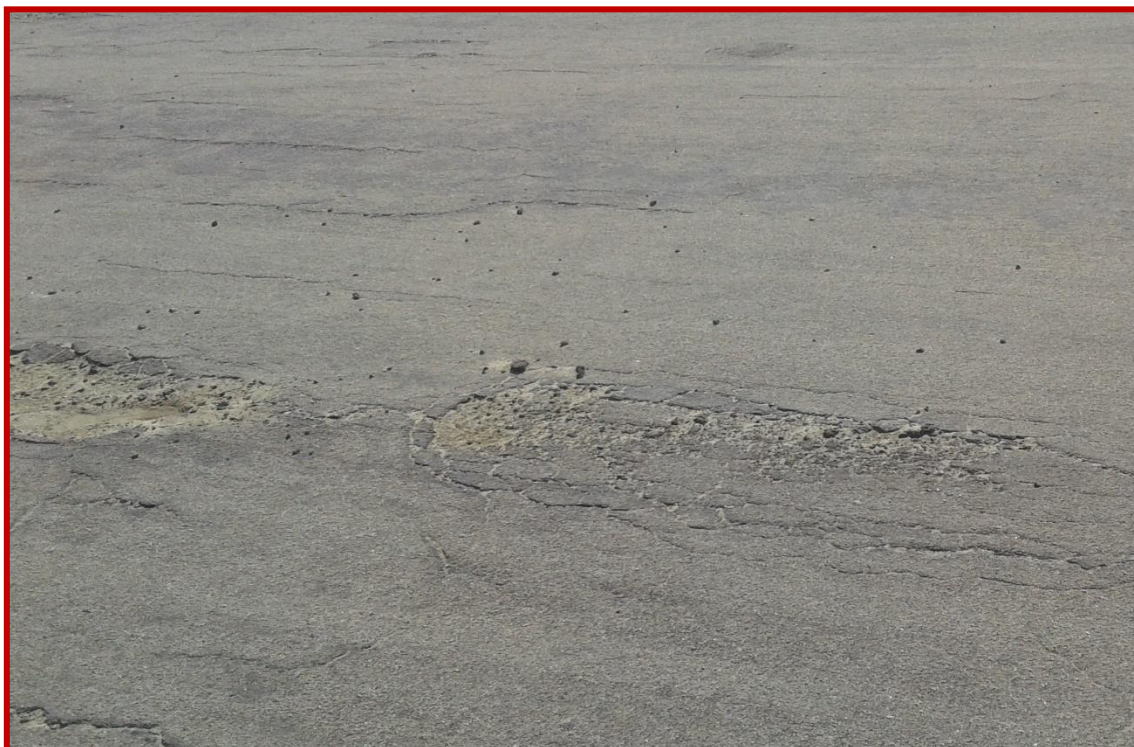
FOTO N° 15: Falla Pérdida de Áridos, encontrada en el Pavimento de la Pista de Aterrizaje del Aeropuerto de Chimbote.
