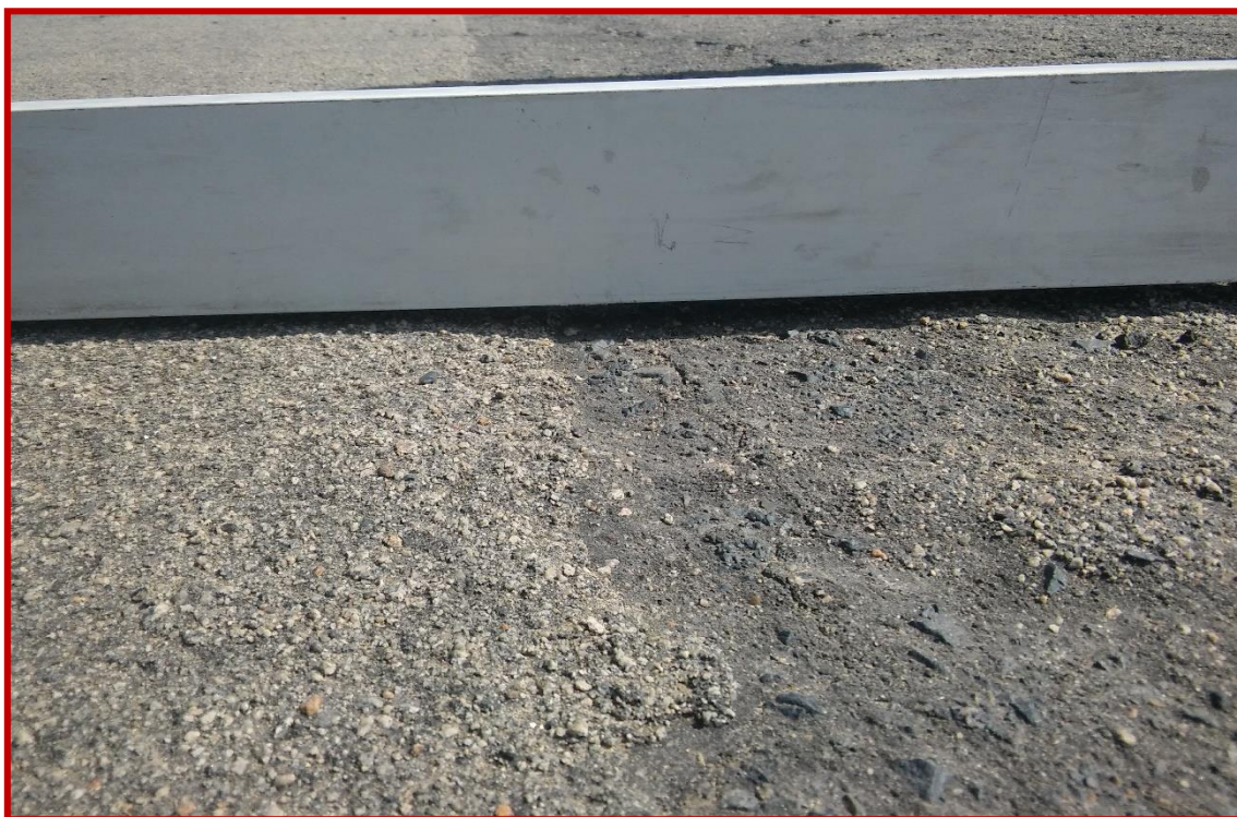
FOTO N° 16: Medición vertical de la falla Pérdida de Áridos, la cual se encontró presente en el Pavimento de la Pista de Aterrizaje del Aeropuerto de Chimbote.
