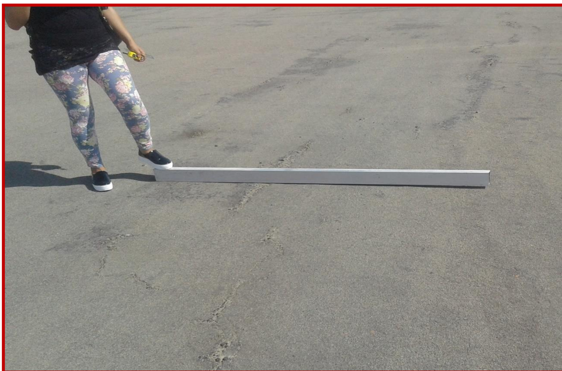
FOTO N° 14: Medición vertical de la falla Depresión, la cual se encontró presente en el Pavimento de la Pista de Aterrizaje del Aeropuerto de Chimbote.
