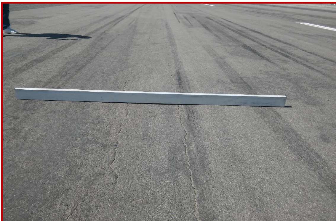
FOTO N° 13: Falla Depresión, encontrada en el Pavimento de la Pista de Aterrizaje del Aeropuerto de Chimbote.
