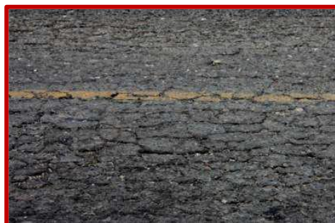
Figura 24. Falla tipo Piel de Cocodrilo
