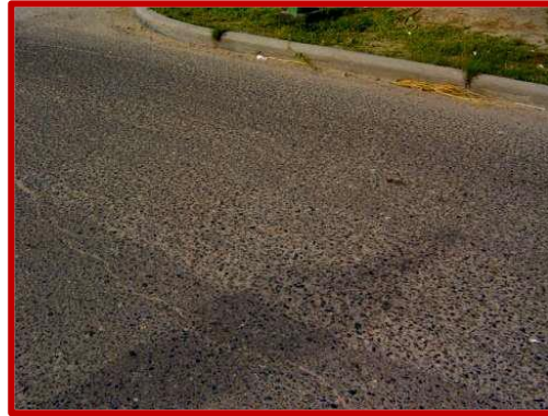
Figura 29. Falla tipo Pérdida de Áridos
