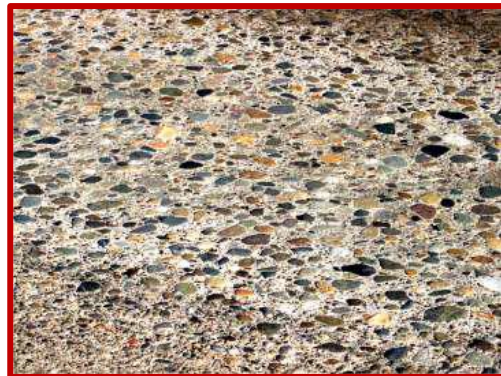
Figura 28. Falla tipo Árido Pulido
