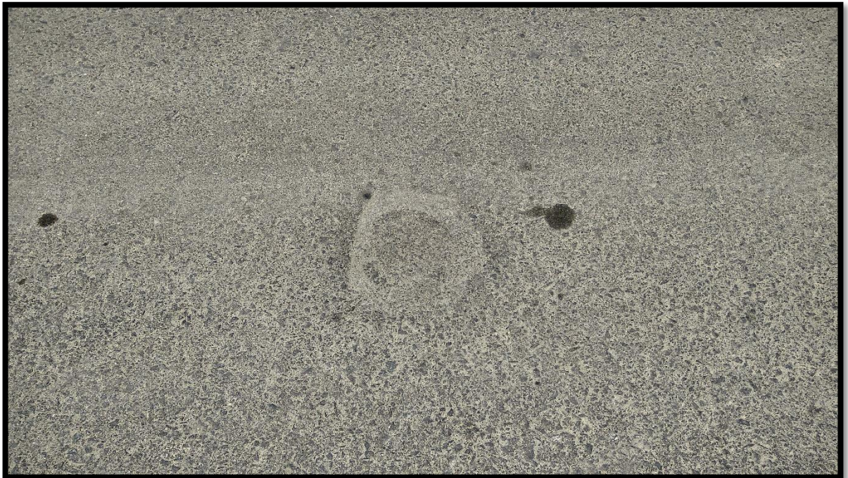
FOTO N°12: Se observa falla de ahuellamiento de alta severidad.
