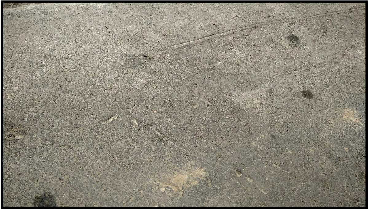
FOTO N°13: Se observa falla de fisura transversal y ahuellamiento.
