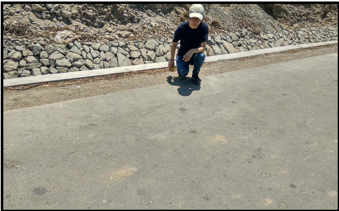
FOTO N°10: Evaluación visual del pavimento.
