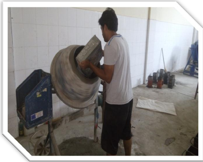
Foto 13: Realizando el procedimiento normal para el mezclado de los componentes en el concreto.
