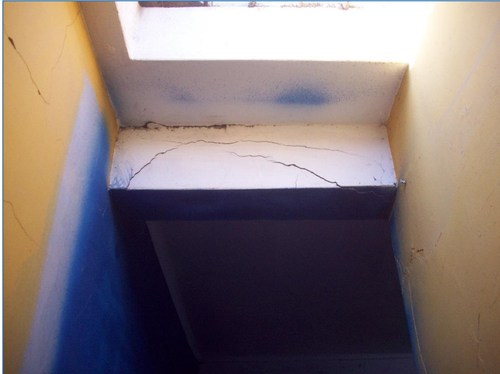
FOTOGRAFIA N° 10.- Grietas en elementos estructurales horizontales en Mz. 10 Lot. 13 del PPJJ La Libertad.
