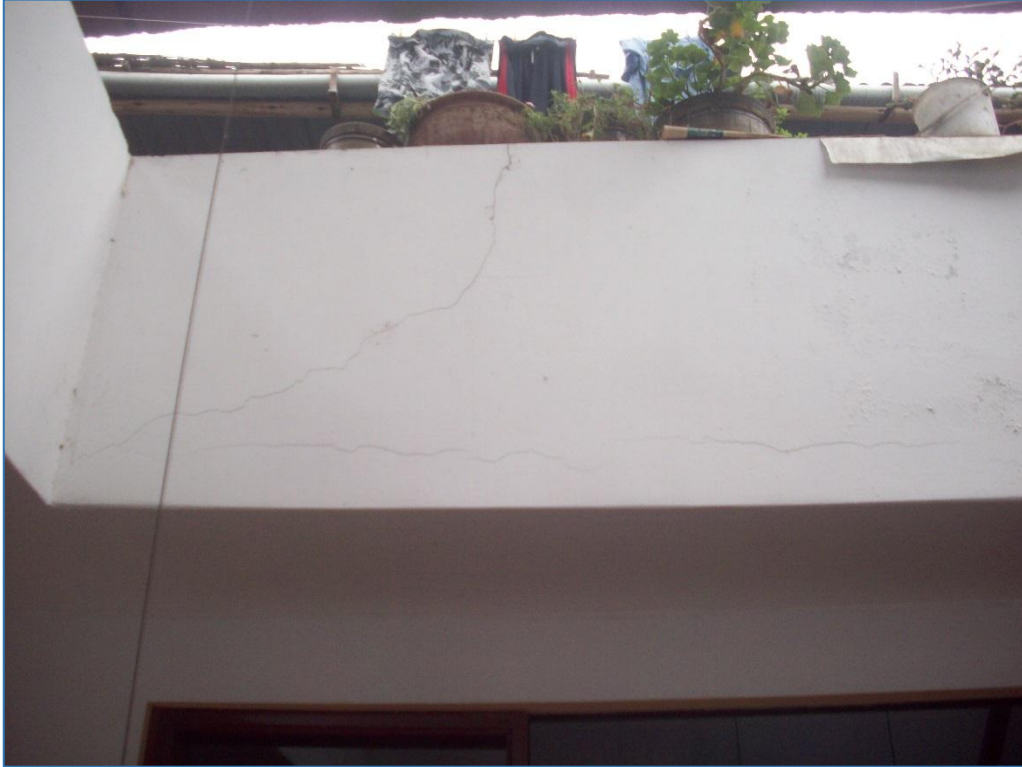
FOTOGRAFIA N° 03.- Ausencia de confinamiento en parapetos de Mz.02 Lot. 28 del PPJJ La Libertad.
