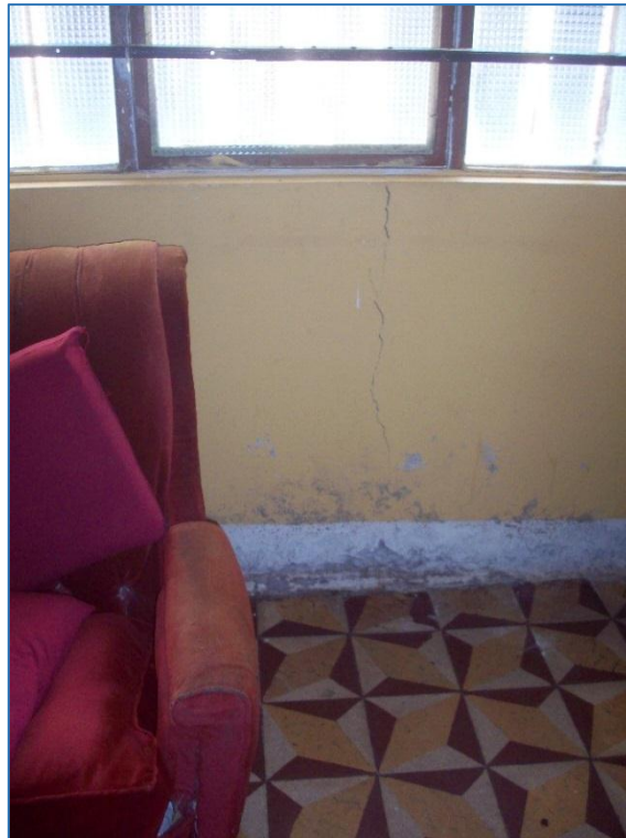
FOTOGRAFIA Nº 08.- Grietas en vanos debido a su falta de aislamiento y confinamiento en la Mz. 09 Lot. 35 del PP.JJ. La Libertad
