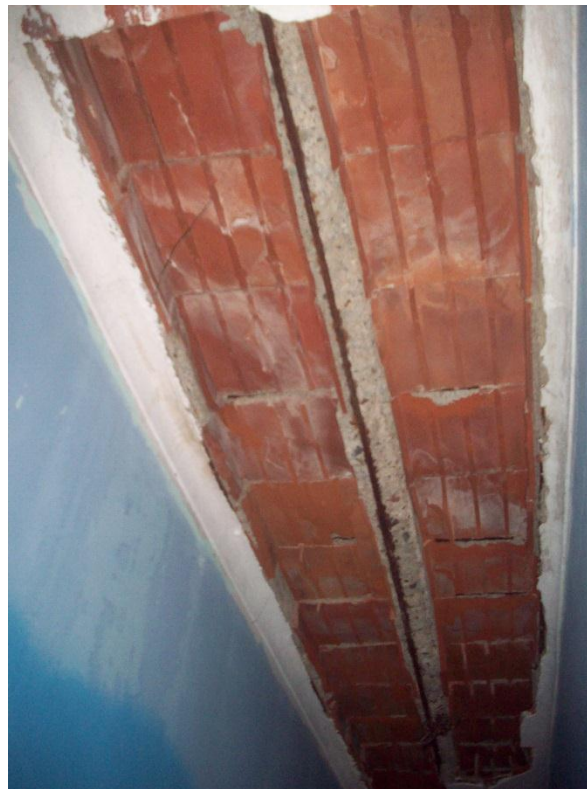
FOTOGRAFIA N° 11.- Desprendimiento de ladrillos en Mz. 10 Lot. 13 del PPJJ La Libertad.
