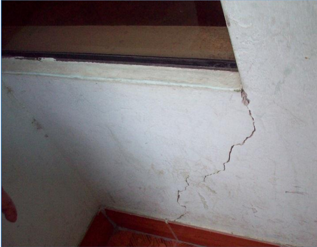
FOTOGRAFIA N° 16.- Ausencia de confinamiento en vanos interiores de la vivienda de la Mz. 20 Lot. 03 del PPJ La Libertad.
