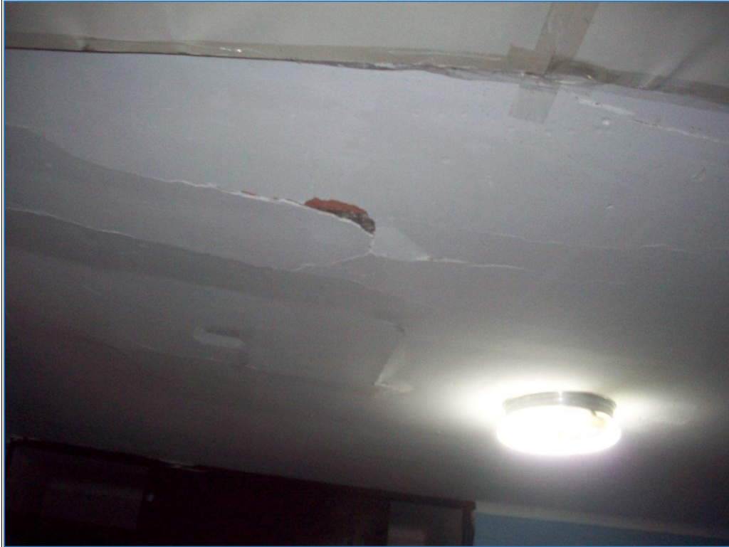
FOTOGRAFIA N° 05.- Desprendimiento de tarrajeo del cielo raso y ladrillos en Mz.03 Lot. 16 del PPJJ La Libertad.
