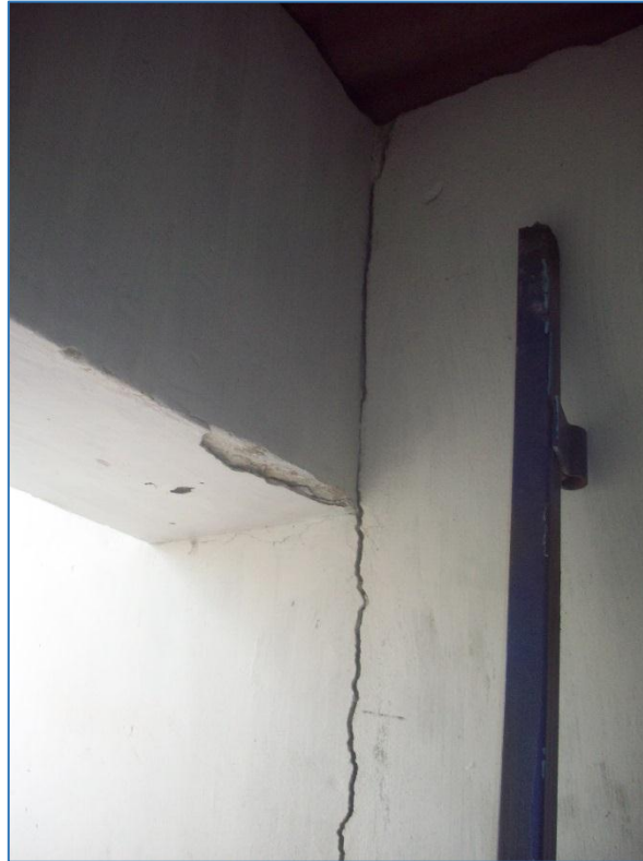
FOTOGRAFIA N° 14.- Falta de confinamiento muro-columna en Mz. 16 Lot. 29 del PPJJ La Libertad.
