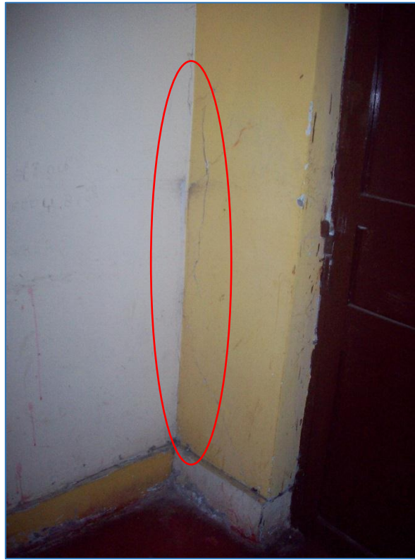
FOTOGRAFIA N° 01.- Grietas en elemento estructural en Mz.01 Lot. 25 del PPJJ La Libertad.
