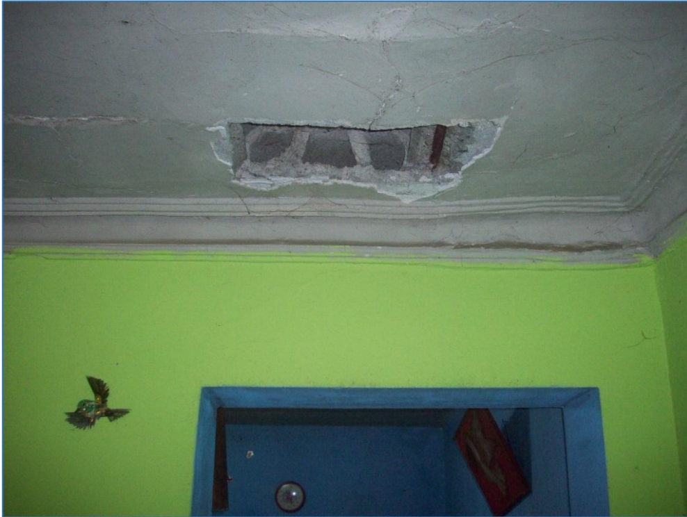
FOTOGRAFIA Nº 07.- Desprendimiento de ladrillo en Mz. 09 Lot. 35 del PPJJ La Libertad.
