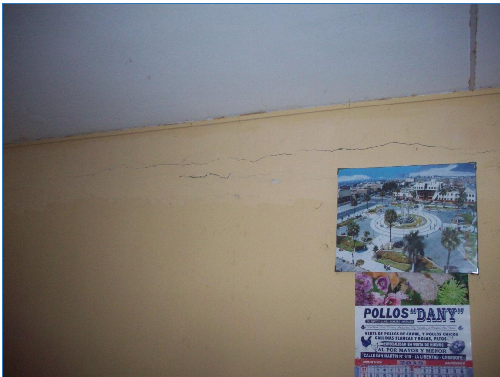
FOTOGRAFIA N° 06.- Grietas en elementos estructurales horizontales en la Mz. 09 Lot. 12 del PPJJ La Libertad.
