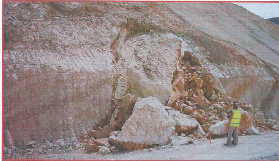
Figura 01: Caída o desprendimiento de bloques. Fuente: Elaboración de los tesisistas.
