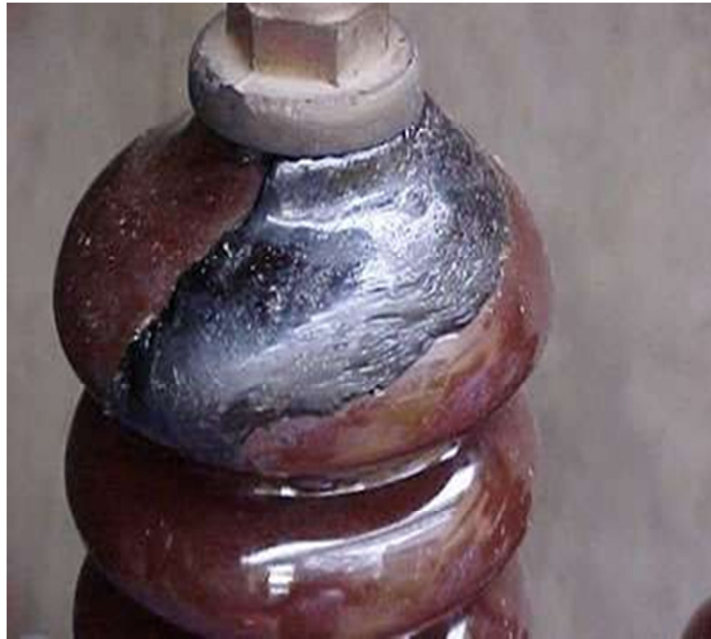
Figura 30. Aislador flameado y corroído
