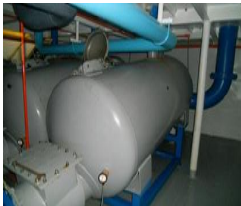
Figura 2.8: Tanque de transferencia
