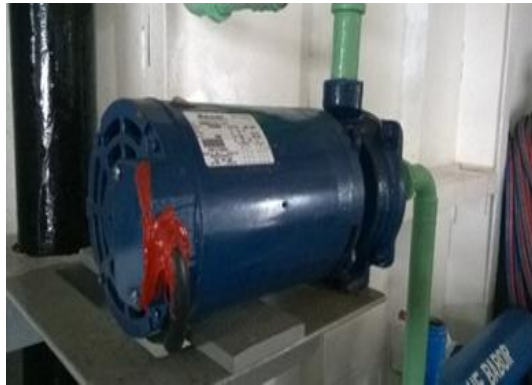
Figura 2.14: Electrobomba de agua de refrigeración
