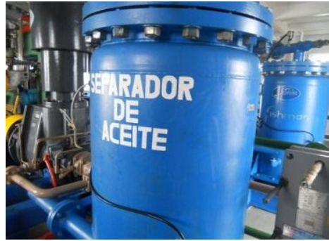
Figura 2.10: Tanque separador de aceite
