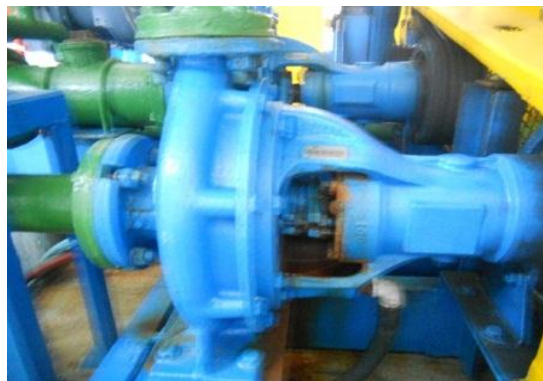
Figura 2.12: Bomba de Enfriador de aceite
