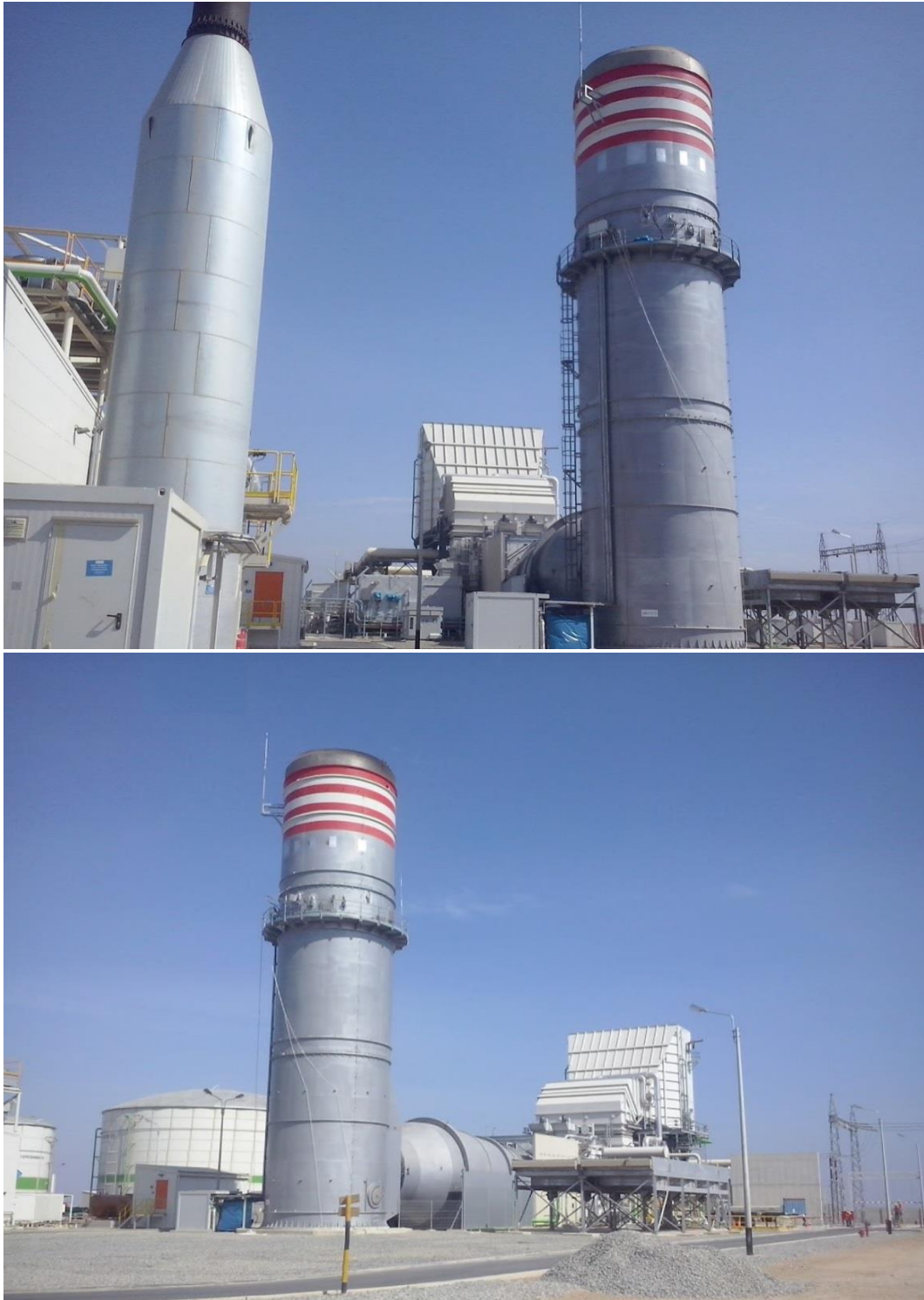
Figura A8: Fotografía del exterior de la Turbina de gas de la Central Termoeléctrica Planta Éten.
