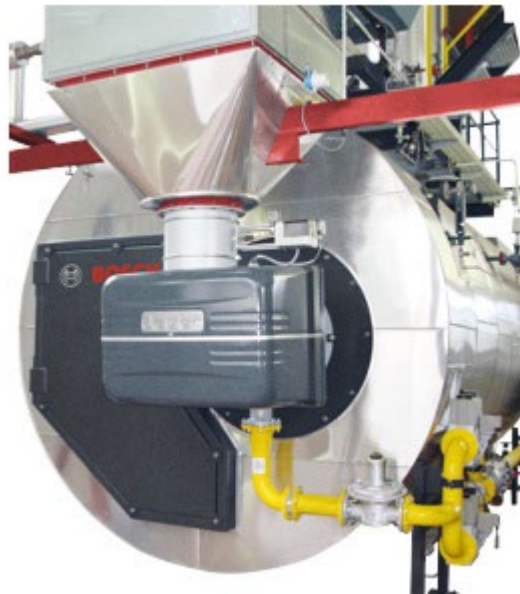
Figura 10 Precalentador de aire ubicado en chimenea de generador de vapor
