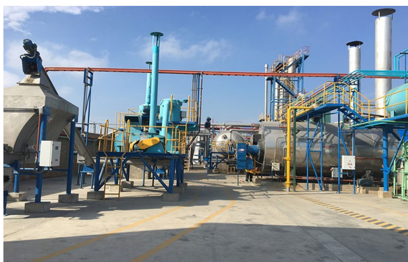
Figura 16 Vista lateral de área de generación de vapor de empresa
