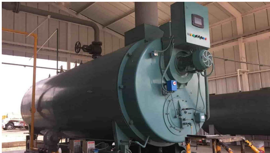
Figura 1 Generador de vapor pirotubular
