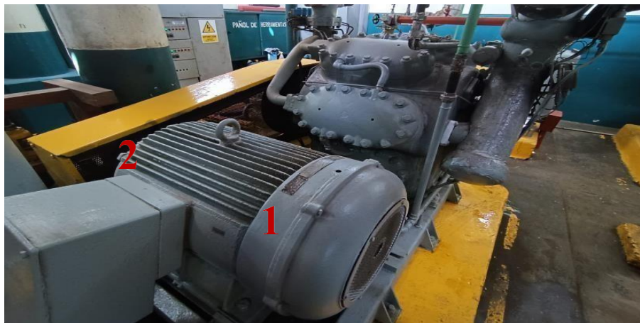
Figura 33 Motor eléctrico del Compresor de Pistones N° 04
