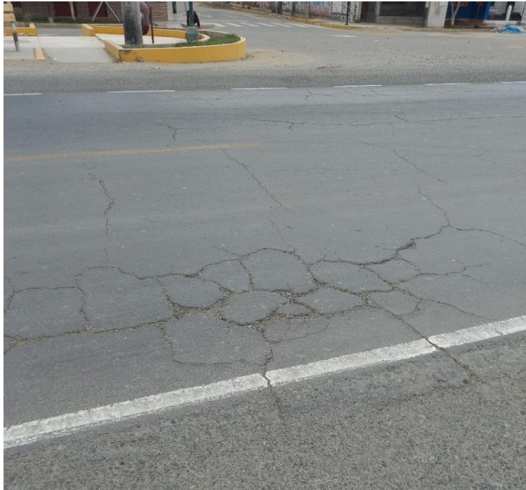
Foto N° 27: Deterioro o falla estructural denominado “Piel de cocodrilo”
