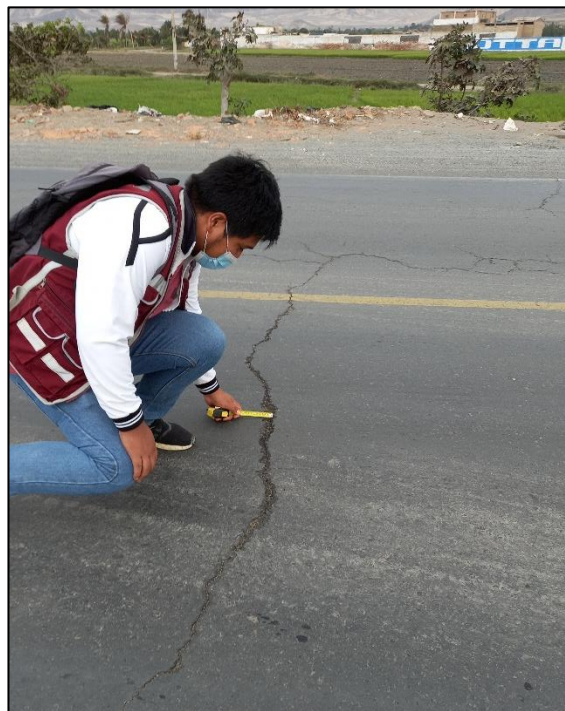
Foto N° 28: Fisura transversal gruesa (ancho > 3\text{mm} ) o “grietas “
