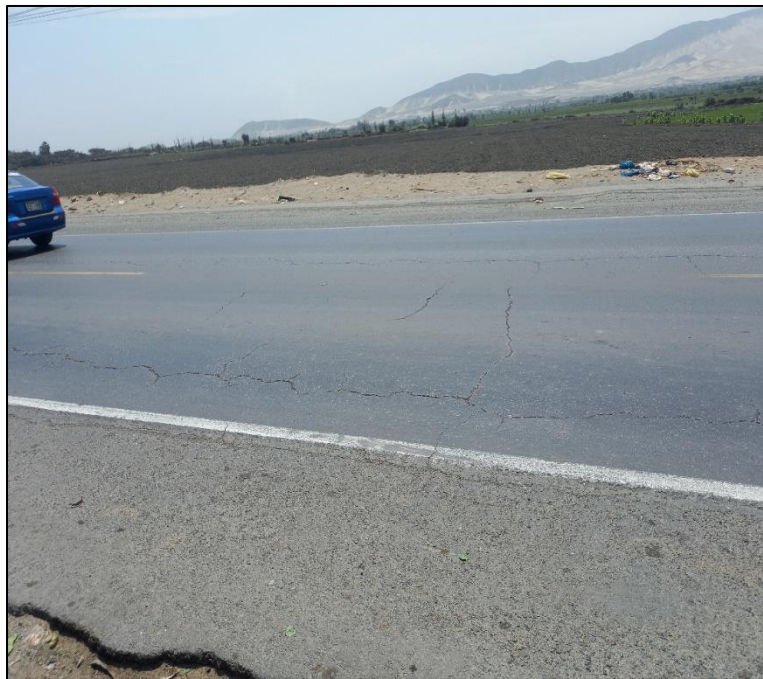
Foto N° 30: Fisuras longitudinales ( ancho > 1\text{mm} y \leq 3\text{mm} )
