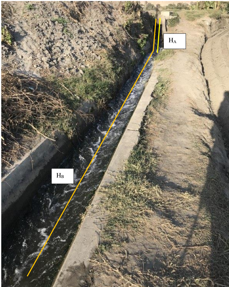
Figura 40. Desnivel de muy baja altura cerca del punto 1
