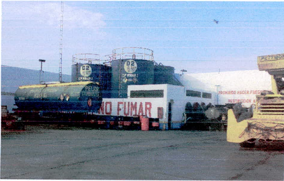
Foto 5: Tanques de Petróleo D2 (Con vista del patio general)
