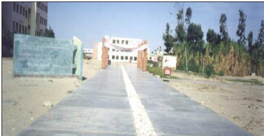
Figura 26. Fibra Óptica viaja subterránea por la Avenida Principal del Campus Universitario
